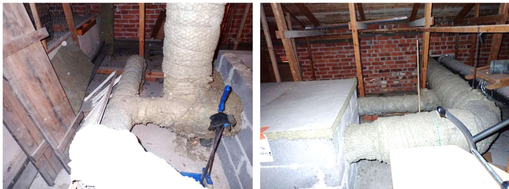
Kuvat 93 a ja b. Keittiön ilmanvaihtokanavisto sijaitsee rakennuksen ullakolla. Ilmanvaihtokanavistossa ei havaittu olevan äänenvaimentimia.
