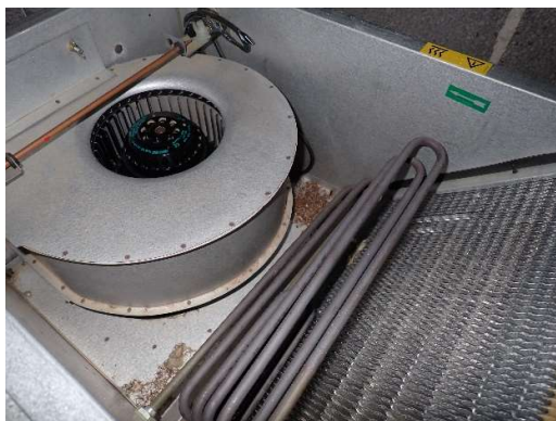
Kuva 77. Tuloilmapuhallin, lämmitysvastus ja ristivirta LTO-kenno. Tuloilma-osa ja LTO-kenno ovat likaiset. Tulo- ja poistoilmapuhaltimissa havaittiin laakerivaurioon viittaavaa sivuääntä. Tuloilman lämmitysvastus oli tarkastushetkellä päällä, eikä sen havaittu reagoivan koneen termostaatin muutoksiin.
