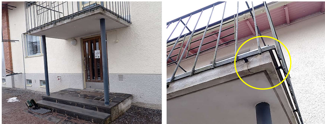
Kuvat 48 a ja b. Luoteen suuntaisella sivulla sijaitsevalla parvekkeella ei ole hallittua sadevedenpoistoa, vaan vedet ohjautuvat sisäänkäynnin betonitasanteelle. Parveke-laatassa on syvä halkeama.
