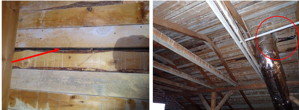
Kuvat 69 a ja b. Aluslaudoituksen takaa havaittiin bitumikermi aluskate. Bitumikermiä ei vesikaton yläpuolelta päästy tarkastelemaan, mutta aluskate ei ainakaan kaikkien läpiviientien kohdalta ole täysin yhtenäinen. IV-läpiviennin kohdalla aluskatteessa on n. 30 cm:n epäjatkuvuuskohta punaisella ympyröitynä sähköjohtojen kohdalla (kuva b).
