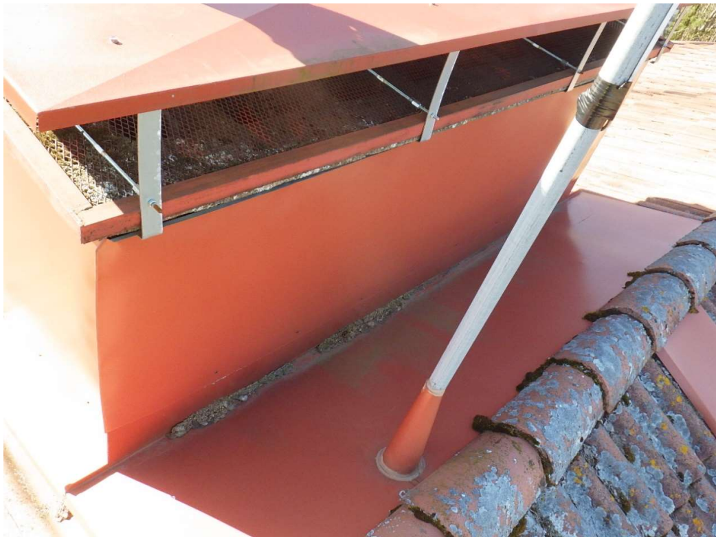
Kuva 73. Ylösnostojen pellitykset ovat uudehkot ja hyväkuntoiset. Pellityksissä ei ole sivuttaissuuntaisia vastakallistuksia. Vastakallistusten puuttuminen ei ole aiheuttanut merkittävää lammikoitumista ylösnoston juureen.
