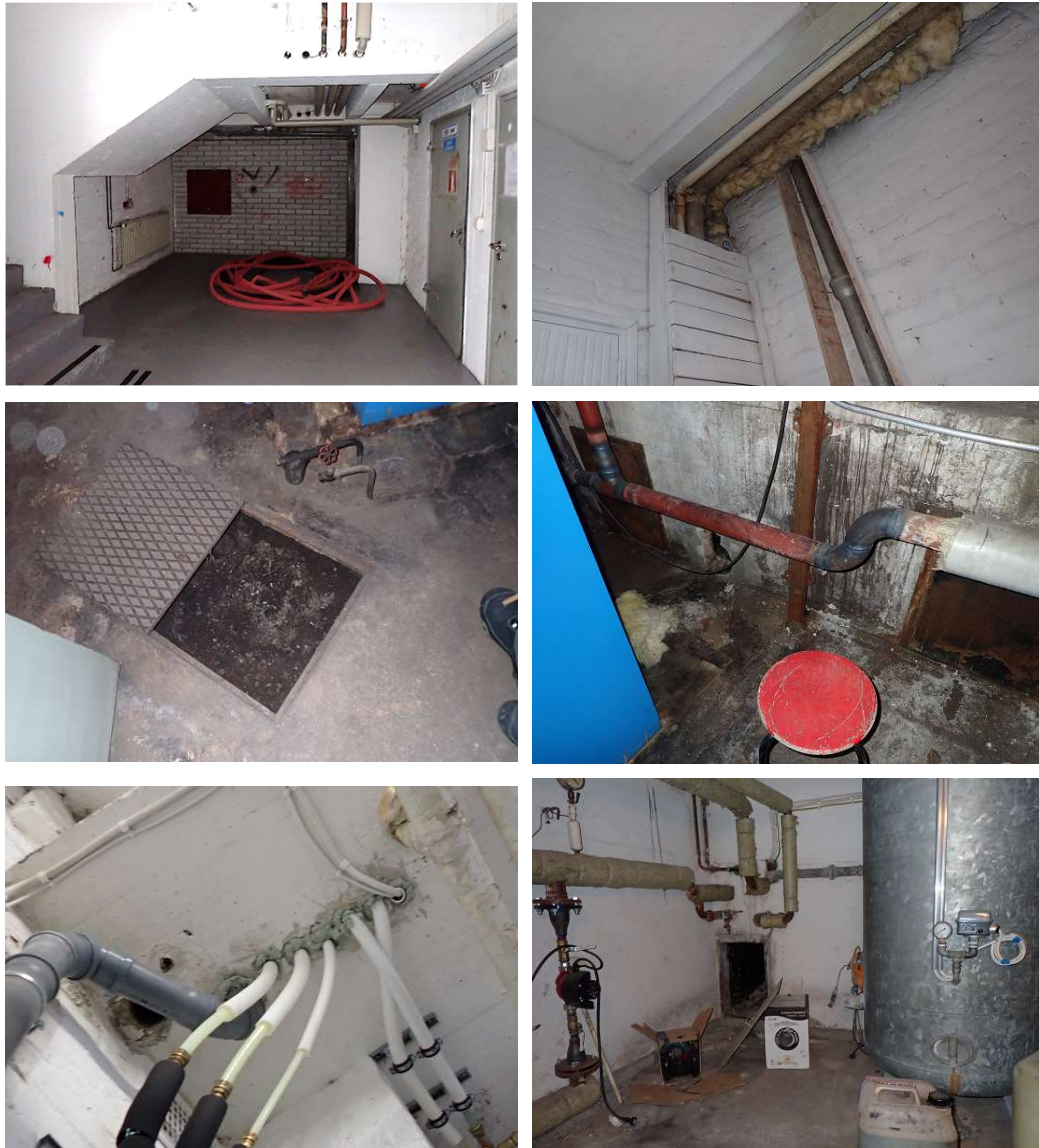
Kuvat 61 a...f. Alakellarin puuvarasto on asetettu käyttökieltoon joulukuussa 2019 (kuvat a, b, e). Yleisesti alakellarin tiloissa on paljon epäpuhtauslähteitä, mm. vanhoja putkieristeistä pinnoilla ja putkikanaalissa, öljyn hajua (öljyä lattialla), epätiivitä lattia- luukkuja ja halkoluukkuja. Kellarin katon läpivientien ilmatiiviydessä on puutteita.
