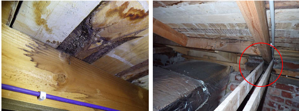
Kuvat 68 a ja b. Vesikaton puurakenteissa havaittiin muutamia kosteuden vaikutuksesta tummentuneita kohtia. Tutkimusten yhteydessä puurakenteet olivat aistinvaraisesti arvioituna kuivia.
