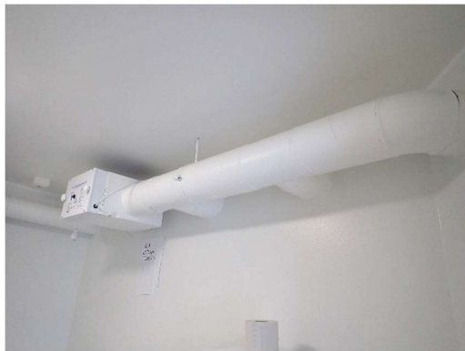
Kuvat 91 a...c. Jälkikäteen rakennetussa lisäsiivessä (korostettu keltaisella värillä) sijaitsevat WC-tilat. Rakennusosa poistoilmanvaihto on toteutettu vesikatolla sijaitsevalla Vilpe huippumurilla. Korvausilmakanavassa on sähkövastuksella varustettu kanavälämmitin.
