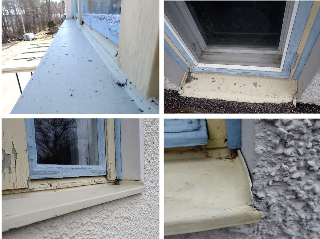
Kuvat 50 a...d. Ikkunoiden ulkopuitteissa ja vesipellityksissä esiintyy paikoin maalin hilseilyä. Ikkunoiden vesipellitykset ovat vaakasuorat ja niiden liitokset julkisivuun eivät kaikilta osin ole vesitiiviitä.
