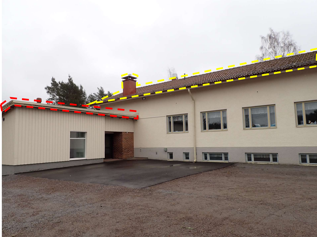
Kuva 70. Yleiskuva rakennuksen vesikatosta. Rakennuksen kattotyyppi on pääosin harjakatto (keltainen merkintä). Vanhan sisäänkäyntikatoksen osalla kattotyyppi on pulpettikatto (punainen merkintä).
