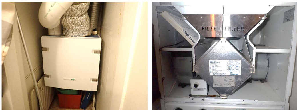
Kuvat 79 a ja b. Vallox 130 iv-kone sijaitsee 2. krs wc-tilassa. Tulo- ja poistoilmapuhaltimessa havaittiin laakerivaurioon viittaavaa sivuääntä.
