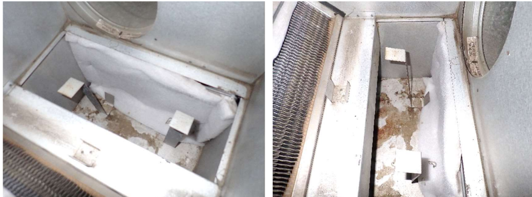
Kuvat 78 a ja b. Tuloilman suodatin-osalla on jälkiä kosteudesta. Suodatinkangas on melko puhdas ja sen suodatusluokka on oletettavasti G3 tai G4.
