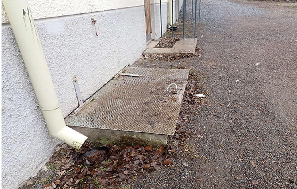
Kuva 8. Koillispäädyn seinän vierustalla maanpinta on paikoin painunut betonirakenteiden ympärillä. Vanhan halkoluukun kantta ei ole liitetty vesitiiviisti sokkeli-/ulkoseinä-rakenteeseen. Vastaavia halkoluukkuja on useampia. Rännikaivoissa oli paikoin runsaasti lehtiä.
