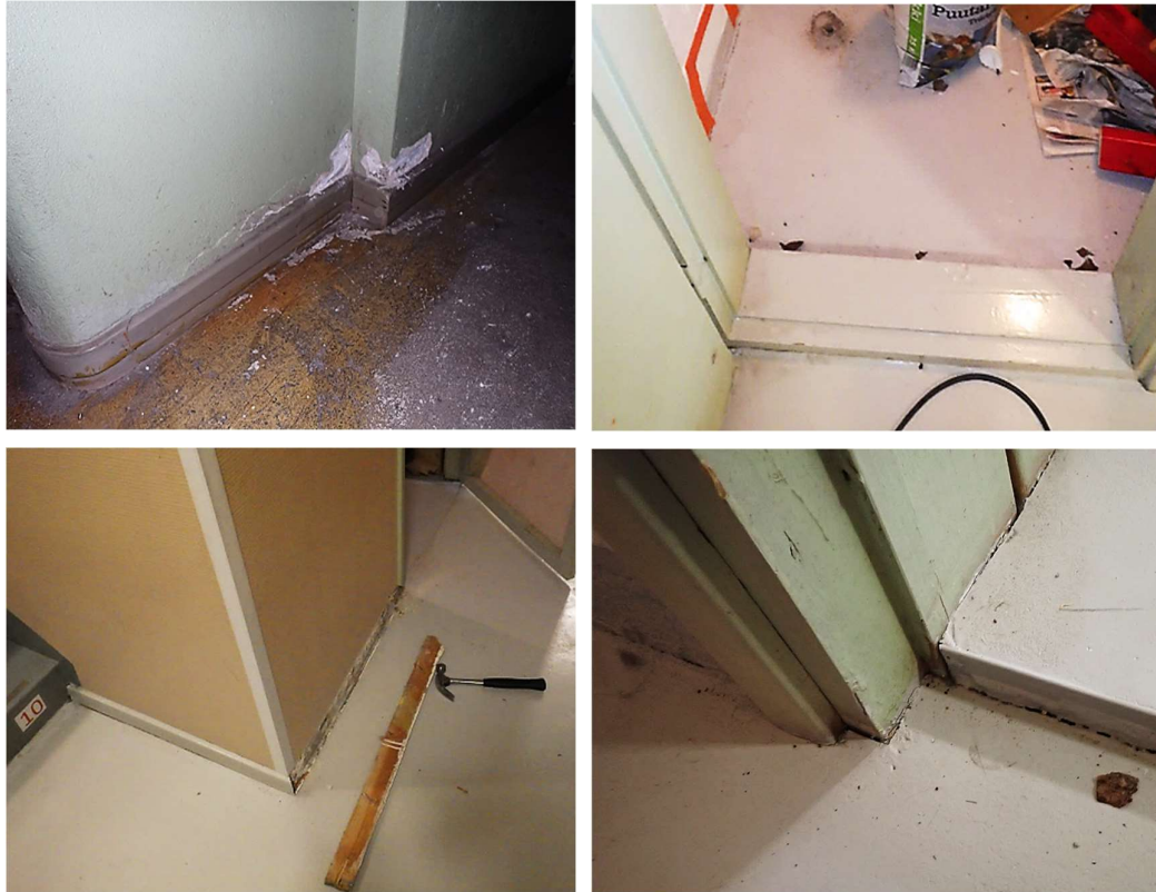
Kuvat 40 a...d. Yksittäinen kosteusvauriokohta kantavan porrashuoneen väliseinän alaosassa alakellarissa (kuva a). Porareikämittauksen perusteella kosteutta nousee maaperästä seinän alaosiin. Kellarissa on yleisesti käytetty puisia jalkalistoja, kynnyksiä sekä betonilaatan sisälle jatkuvia ovenkarmeja.
