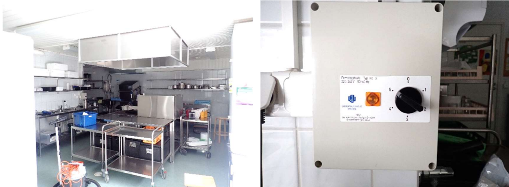
Kuvat 84 a ja b. Keskellä keittiötilaa on rasvahuuva, joka on yhdistetty vesikatolla sijaitsevaan muuntajateho-ohjattuun huippumuriin. Rasvahuuvan poistoilmalle ei havaittu olevan korvausilmakompensointia.
