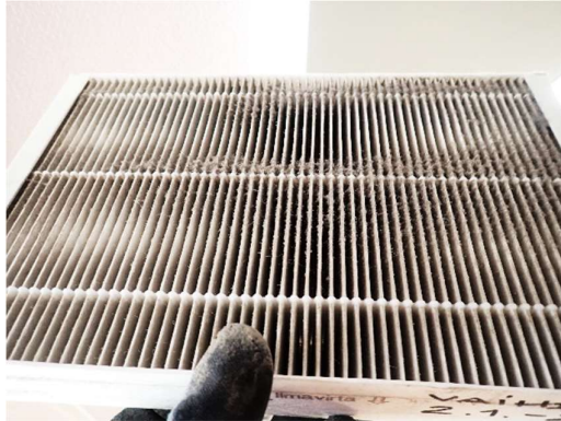
Kuva 83. Korvausilmalaitteiden suodattimet olivat likaisia. Suodattimet olivat merkintöjen mukaan vaihdettu 2.1.2020.
