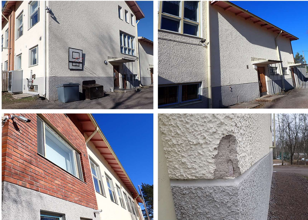
Kuvat 47 a...d. Rakennuksen rapatuissa ja muuratuissa julkisivuissa ei silmämääräisen tarkastelun perusteella esiinny laajoja vaurioita. Yksittäinen rappauksen lohkeama havaittiin rakennuksen länsinurkassa (kuva d).
