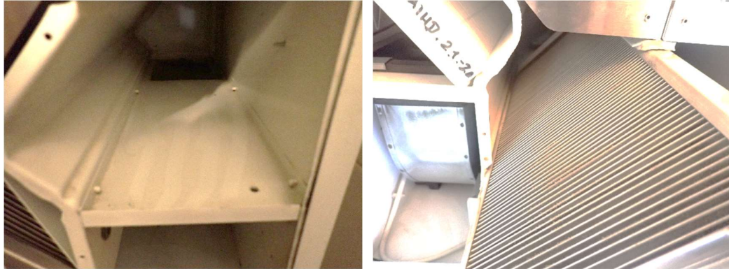
Kuvat 80 a ja b. Ilmanvaihtokone ja lto-kenno on melko pölyisiä.
