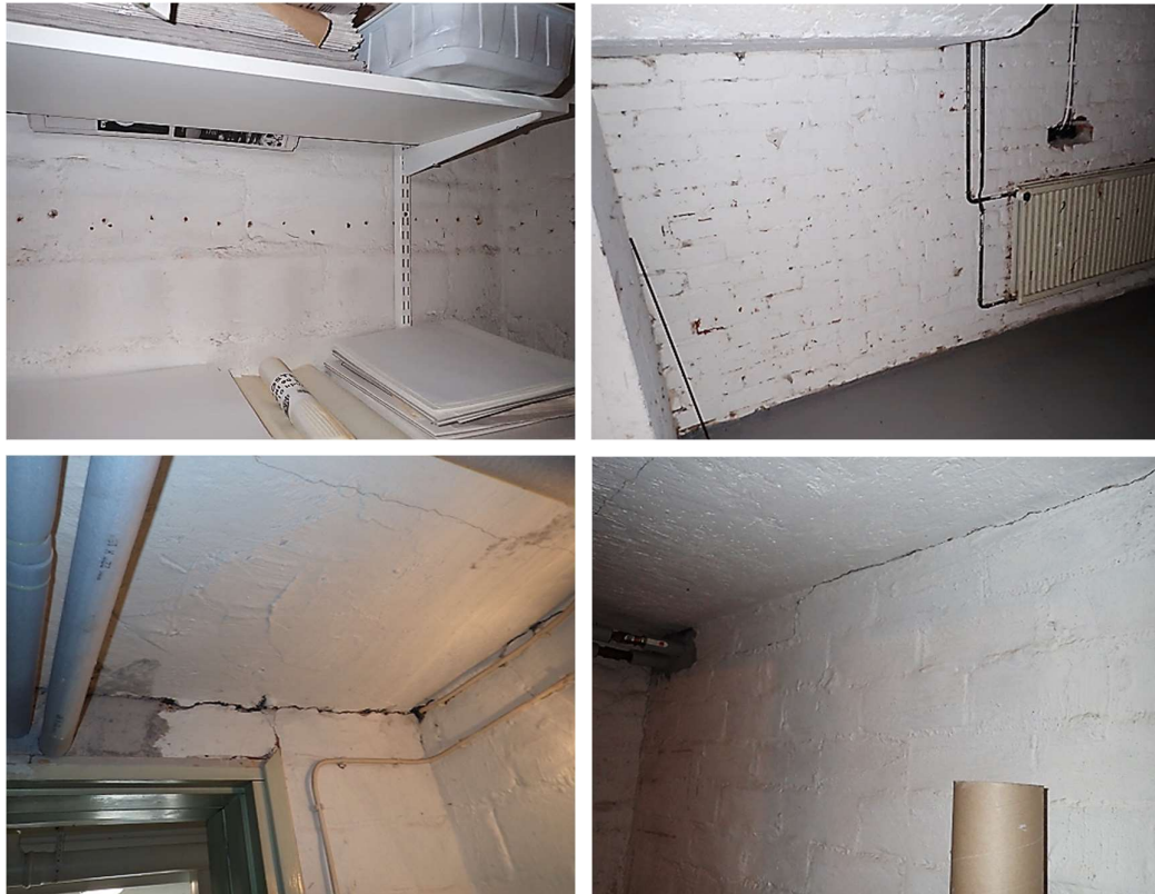
Kuvat 41 a ja b. Pääosassa kellarin tiloja ulkoseinien ja lämmöneristettyjen väliseinien muuraus on aistinvaraisesti havaittavissa ohuen tasoitteen alta. Muurauksen ilmatiivyyttä heikentää mm. kiinnikkeet, reiät ja halkeamat.
