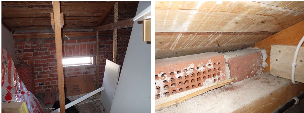
Kuvat 67 a ja b. Räystäällä ei havaittu selkeää tuuletusrakoa, mutta paikoin räystäältä kajastaa päivänvaloa. Kädellä tunnusteltaessa räystäällä oli havaittavissa heikko ilmavirtaus.
