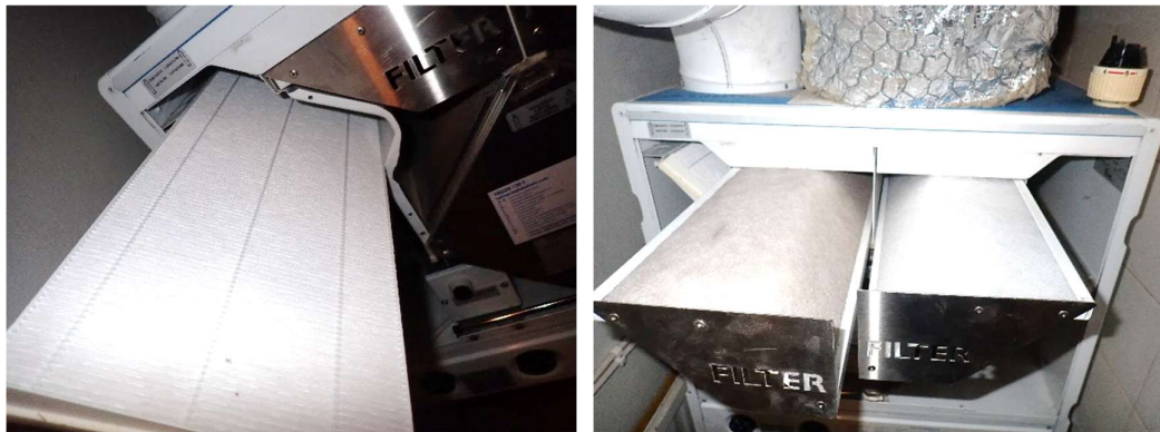
Kuvat 81 a ja b. Vasemmanpuoleisessa kuvassa oleva tuloilman hienosuodatin on puhdas ja oli suodattimeen kirjatus tiedon mukaan vaihdettu 2.1.2020. Oikeanpuoleisessa kuvassa olevat tulo- ja poistoilman karkeasuodattimet ovat hieman pölyiset, poistosuodatin hieman likaisempi.
