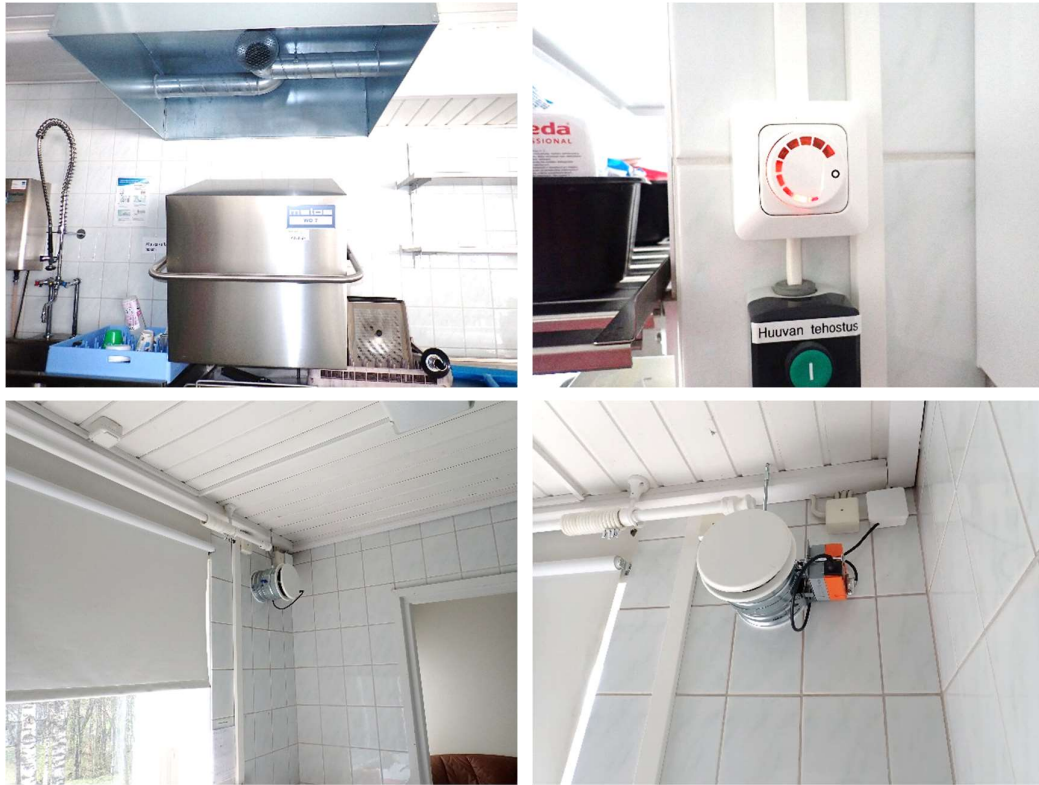
Kuvat 85 a...d. Astioidenpesupaikalla on erillinen tyristoriteho-ohjattu kondenssihuuva, joka on yhdistetty keittiötilassa sijaitsevaan poistoilman kanavapuhaltimeen. Kondenssihuuvan korvausilmakompensointi on toteutettu keittiötilassa olevalla moottoriohjatuulla korvausilmaventtiilillä. Kanavapuhaltimen käynnistyessä moottoripelti avautuu.
