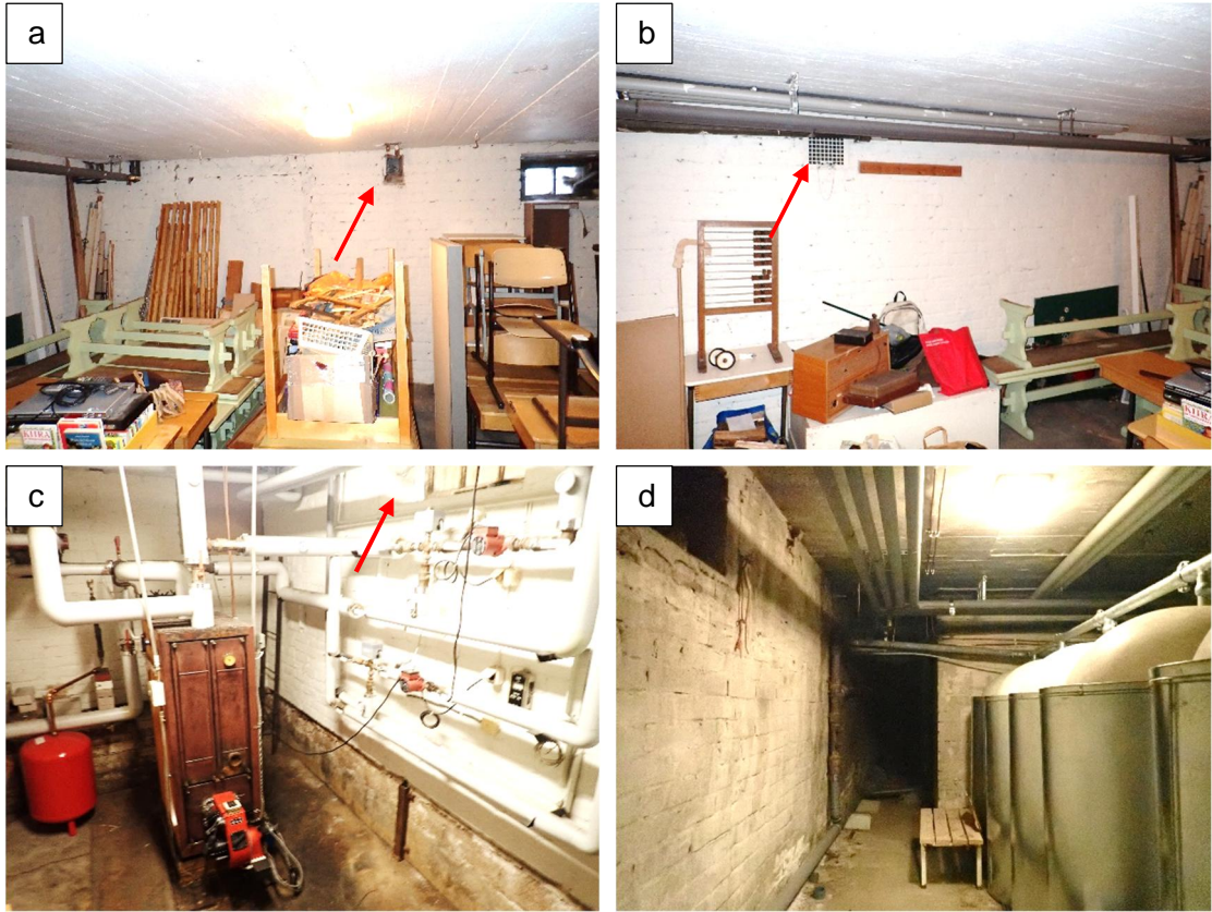
Kuvat 111 a...d. Yleiskuvia kellaritilojen ilmanvaihdosta. Punaisilla nuolilla on osoitettu korvausilma-aukkoja ja poistoilmahormeja ja poistoilmaventtiileitä.
