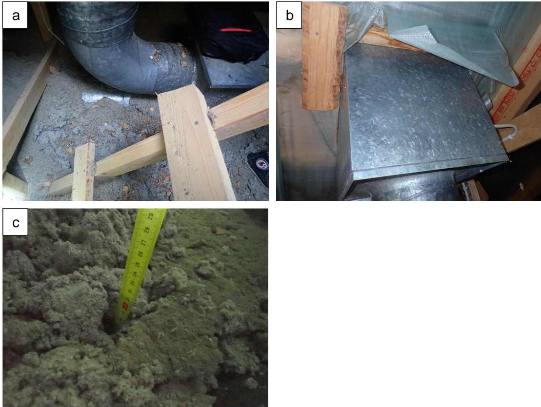
Kuvat 98 a...c. Yläpohjatilassa on lämmöneristämätön ilmanvaihtokanava (kuva a). Huippumurin läpiviennin liitos aluskatteeseen on puutteellinen. Läpiviennissä havaittiin vähäisiä vesivalumajälkiä (kuva b). Yläpohjan puhallusvillaeristeen paksuus on hieman yli 200 mm (rakennetarkastelu RAK1.13 YP, kuva c).
