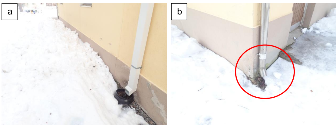
Kuvat 9 a...b. Rännikaivojen läheisyydessä rakennuksen sokkelin alaosaan havaittiin paikoin vähäisiä kosteuden aiheuttamia jälkiä ja maalipinnan hilseilyä. Laajennusosan pohjoispään varaston kohdalla syöksytorvi kastelee sokkelin alaosaan laajemmin.
