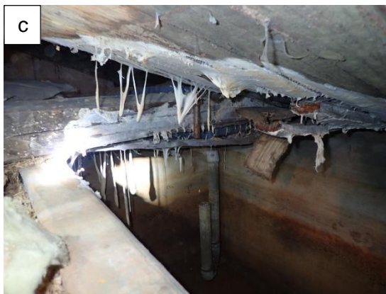
Kuvat 92 a...c. Rakennuksen keskialueella yläpohjan muottilaudoituksissa havaittiin valkoista sienikasvustoa erityisesti yläpaisuntasäiliön läheisyydessä sekä paisuntasäiliön yläpuolisissa puurakenteissa.
