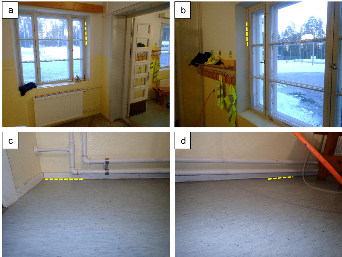
Kuvat 74 a...d. Merkkiainekoe MK1. Keltaisella katkoviivalla merkityissä kohdissa havaittiin vähäistä ilmavuotoa.
