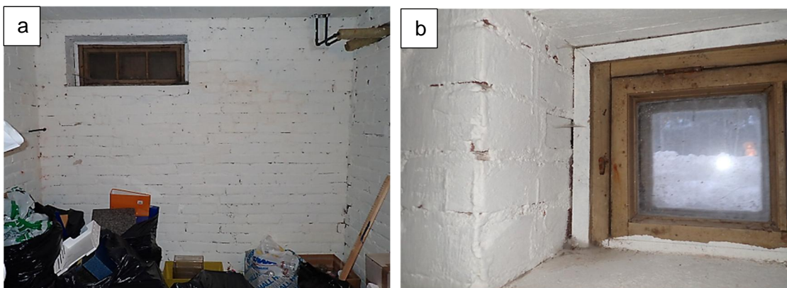
Kuvat 19 a...b. Kellarin maanvastaisissa ulkoseinissä on ilmatiiviyspuutteita verhomuurauksessa (kuva a) ja ikkunaliittymissä (kuva b).
