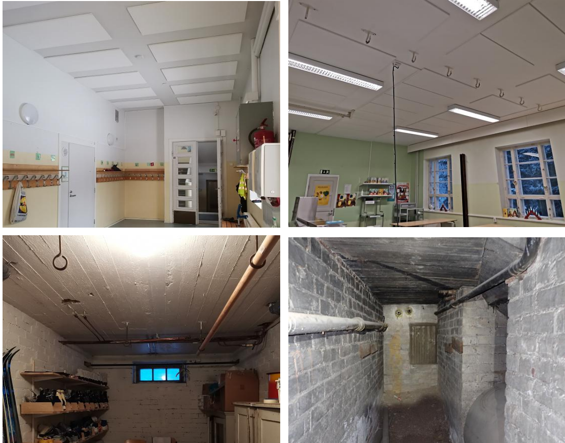
Kuvat 78 a...d. Yleiskuvia välipohjien alapinnoista. Pinnat ovat pääosin hyväkuntoisia. Kellaritilojen kattopinnat ovat paikoin likaantuneet käyttöön liittyvästä toiminnasta (kuva d).
