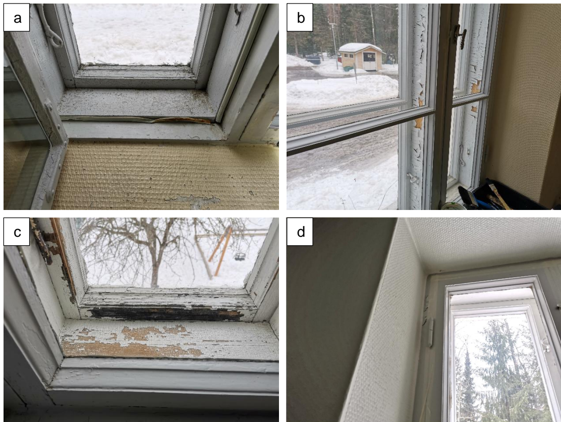
Kuvat 53 a...d. Ikkunoiden puuosissa havaittiin monin paikoin maalipintojen voimakasta hilseilyä ja ulkopuolteissa paikoin alkavaa puuosien pehmenemistä (kuva c). Ikkunatiivisteet ovat huonokuntoisia. Useissa ikkunoissa oli käytetty tiivistysteippiä ilma- vuotojen estämiseen. Ikkunaliittymien ilmatiiveys ulkoseinärakenteeseen on havaintojen, merkkinavutarkasteluiden ja merkkiainekokeen perusteella varsin hyvä.
