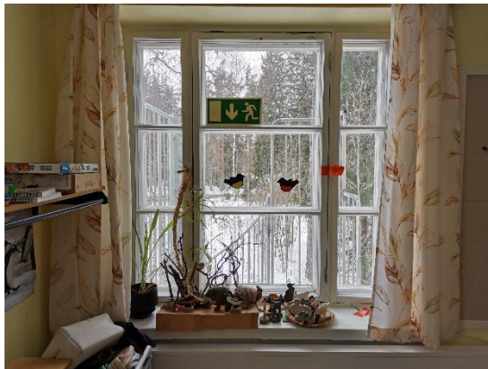
Kuva 55. Hätäpoistumistie 2. kerros. Hätäpoistumistien edusta on täynnä tavaraa.
