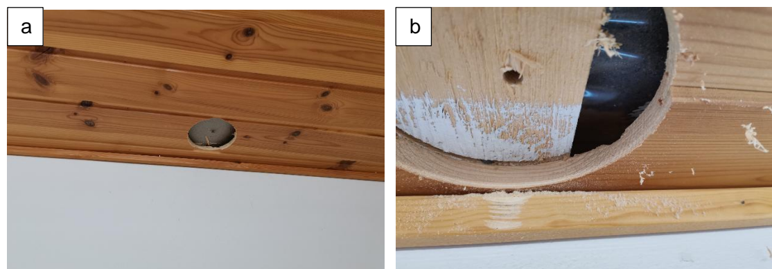
Kuva 103 a...b. Laajennusosan yläpohjan höyrynsulun liittymiä tarkasteltiin myös sisäkautta kahdella rakenneavauksella (RAK1.13...1.14 YP). Höyrynsulkumuovi jatkuu ehjänä tiiliväliseinän yli (kuva a). Ulkoseinän liitoksen toteutusta ei rakenneavauskohdasta saatu tarkemmin selvitettyä, koska avauskohdassa oli koolauspuiden tunnistelulla höyrynsulku todettiin yhtenäiseksi liitoskohdassa. Myöskään ilmavuotoa ei kohdassa havaittu merkkisavutarkastelulla. Yläpohjan höyrynsulku jatkuu limitettynä ulkoseinärakenteen sisään.
