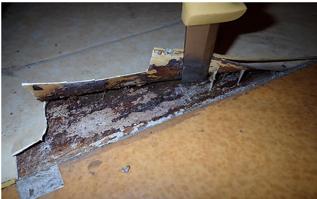
Kuva 41. Alapohjan lattiapäällysteen tarkastelu kellarin pukuhuoneen viereisessä suihkutilassa. Poikkeavaa hajua, liimakerros selvästi vaurioitunut ja siinä on värimuutoksia.
