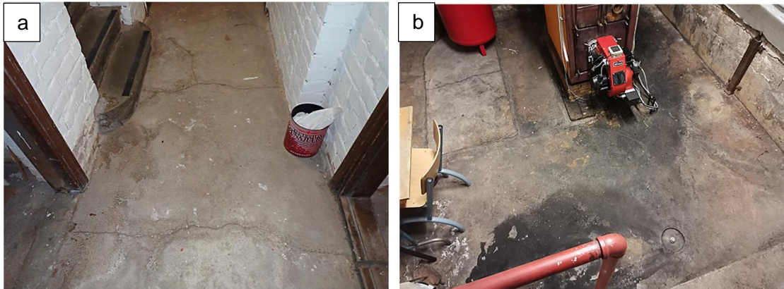
Kuvat 14 a...b. Alkuperäisosan kellarin alapohjien pinnat ovat kuluneita ja lattia halkeilee monin paikoin. Lämmönjakohuoneen lattiassa on laajalla alueella öljyn jälkiä.
