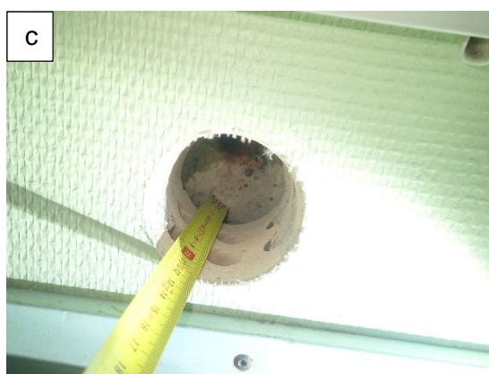
Kuvat 61 a...c. Rakenneavaukset PR1.6 US, PR1.7 US/RAK1.5 US ja PR1.8 US (vanha ulkoseinä) lännen ja pohjoisen puoleisiin sivuihin 1.kerrokseen. Porauksissa PR1.6 ja PR1.8 US havaittiin noin 100 mm:n ilmapäli noin 280 mm syvyydessä. Ikkunan alapuolissa avauksessa PR1.7 US/RAK1.5 US todettiin vanhan patterisyyvennyksen olevan muurattu umpeen reikätiilillä. Reikätiilen takana on noin 40 mm ilmapäli ennen alkuperäistä rakennetta. Ulkoseinärakenteen kokonaispaksuus on noin 500 mm. Avauksista PR1.6 ja PR1.8 todettiin voimakasta ilmavirtausta sisään päin. Poikkeavaa hajua avauksista ei havaittu.
