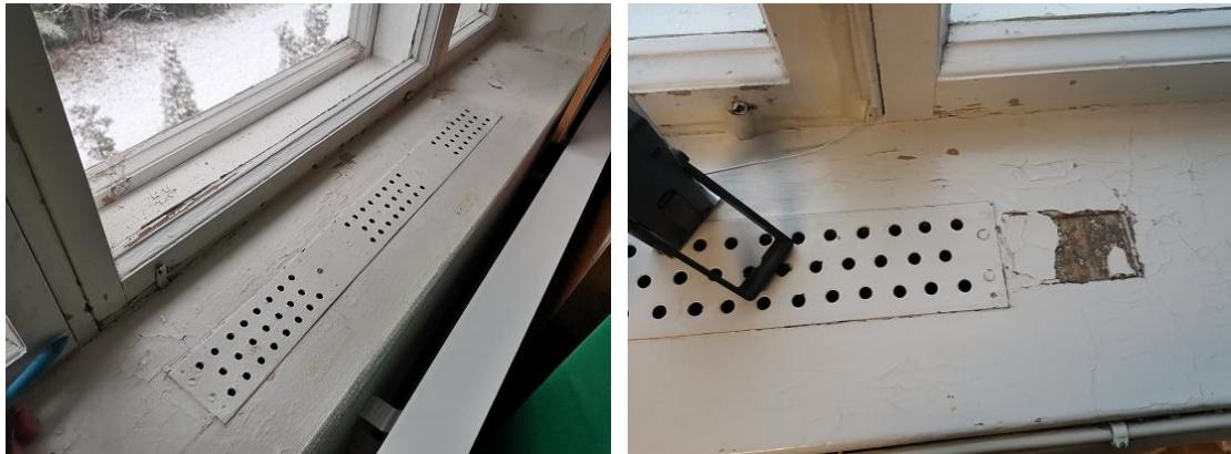
Kuvat 54 a...b. Yksittäisissä toisen kerroksen ikkunapenkeissä havaittiin metallisten tuuletusritilöiden kautta ilmayhteys ulkoseinän sisälle. Tutkimushetkellä ei havaittu ilmavirtauksia sisälle päin.
