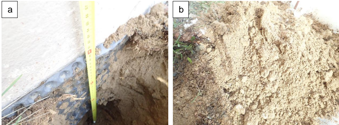
Kuvat 7 a...b. Koekuoppa 1, alkuperäisen osan itäpuolelle. Kaivussyvyys noin 500 mm, vierustäyttö on hienorakeista hiekkaa, pinnassa multaa. Lämmöneristeitä ei havaittu.
