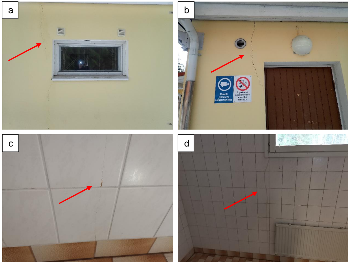
Kuvat 56 a...d. Laajennusosan julkisivussa havaittiin useita pitkiä pystysuuntaisia halkeamia (kuvat a-b). Halkeamia havaittiin myös sisäverhouksissa ja pesuhuoneiden laatoituksissa (kuvat c-d).
