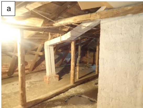
Kuva 113. Rakennuksen ullakolla on asbestipitoisesta materiaalista valmistettu ilma- vaihtokanava, joka on yhdistetty rakenneaineiseen ilmanvaihtohormiin.
