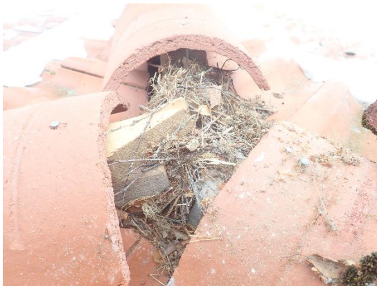
Kuva 99. Laajennusosan vesikaton harjatiilen alle on kertynyt hieman roskaa.
