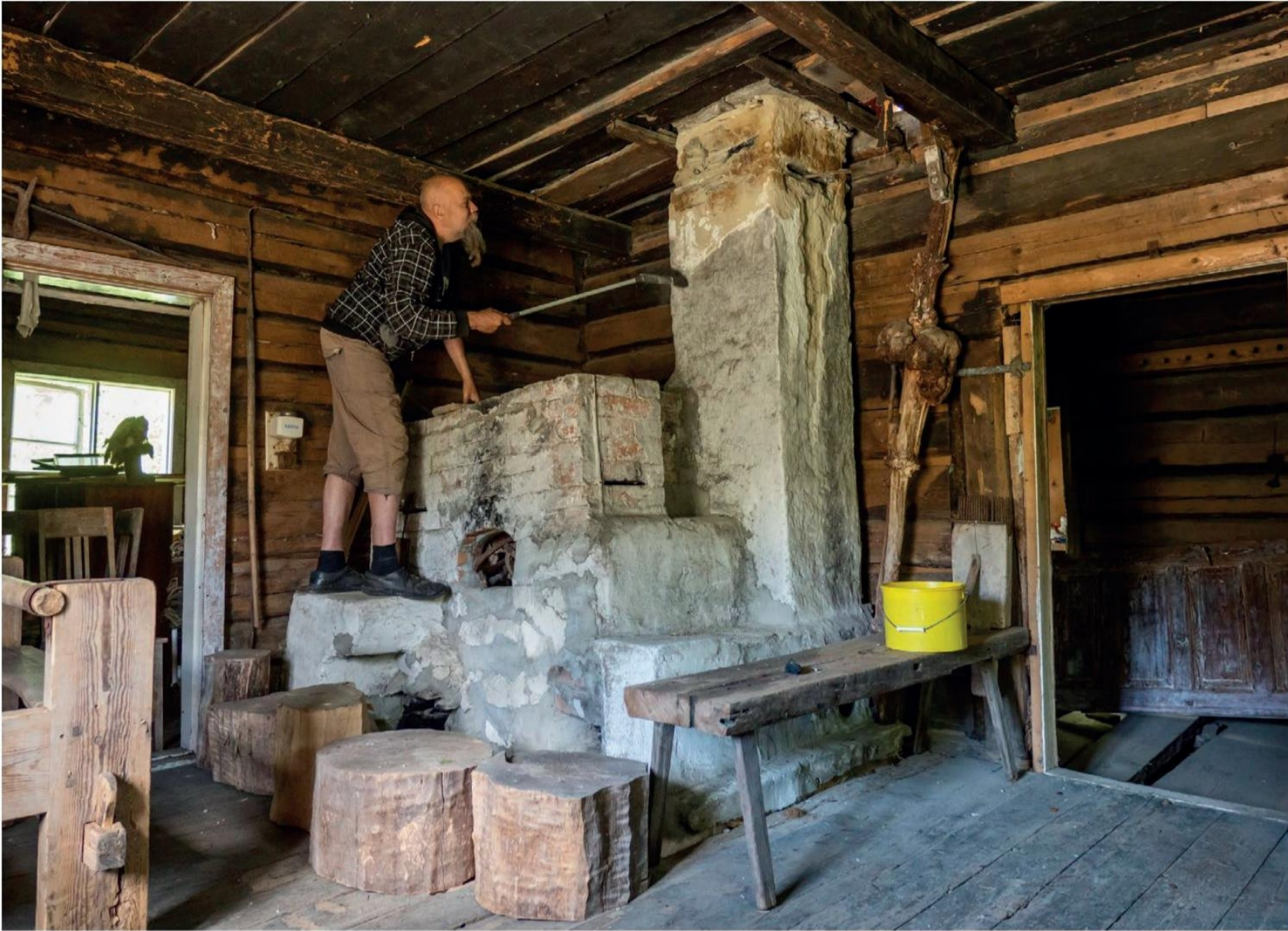
■ Meneillään on vanhan uunin pintapuhdistus. Uuni on osin sortunut ja kallistunut, koska mäyrät ovat pesineet talon alarakenteissa. Kuvat: Juha Jäntti
