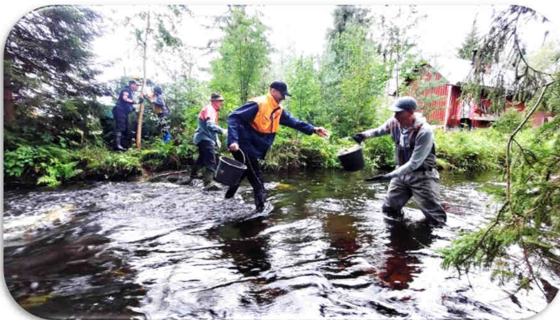
Sora saatiin siirrettyä rivakasti koneen avulla uoman viereen, josta se siirtyi ihmisketjun voimin uomaan.
