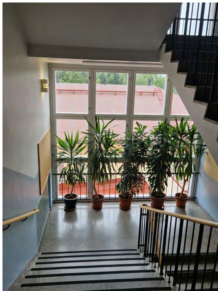
Vuonna 1955 valmistuneen laajennuksen päätyporras. Kaiteet ovat alkuperäiset ja niissä joka kolmas pystyjohde latta. Ikkunat on uusittu. EK
