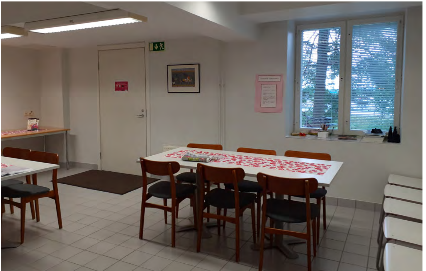
Vuoden 1931 osan kellarikerroksessa on nykyään henkilöstön taukotiloja. Itäpihalle johtavaan oviaukkoon on sisäpuolelle lisätty umpiovi, mikä vähentää luonnonvaloa tilassa. Ikkuna-aukossa ei ole mosaiikkibetonista ikkunapenkkiä muista ikkunoista poiketen. Alareunassa kaakelit. KS
