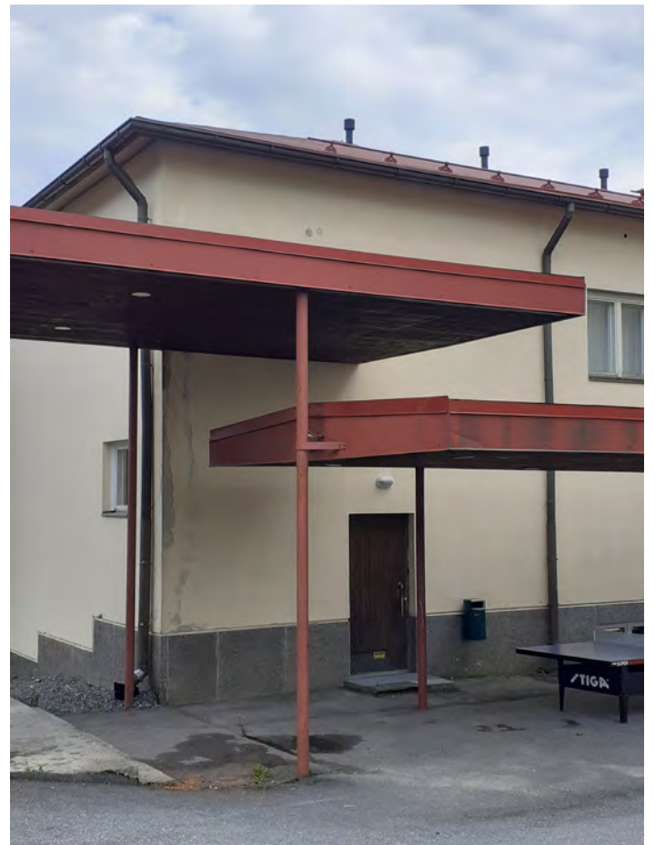
1973 rakennettu yhdyskatos B-osaan on osittain kiinni liikuntasaliin julkisivussa. Alkuperäinen vuoden 1955 ulko-ovi porras-huoneeseen. KS.
