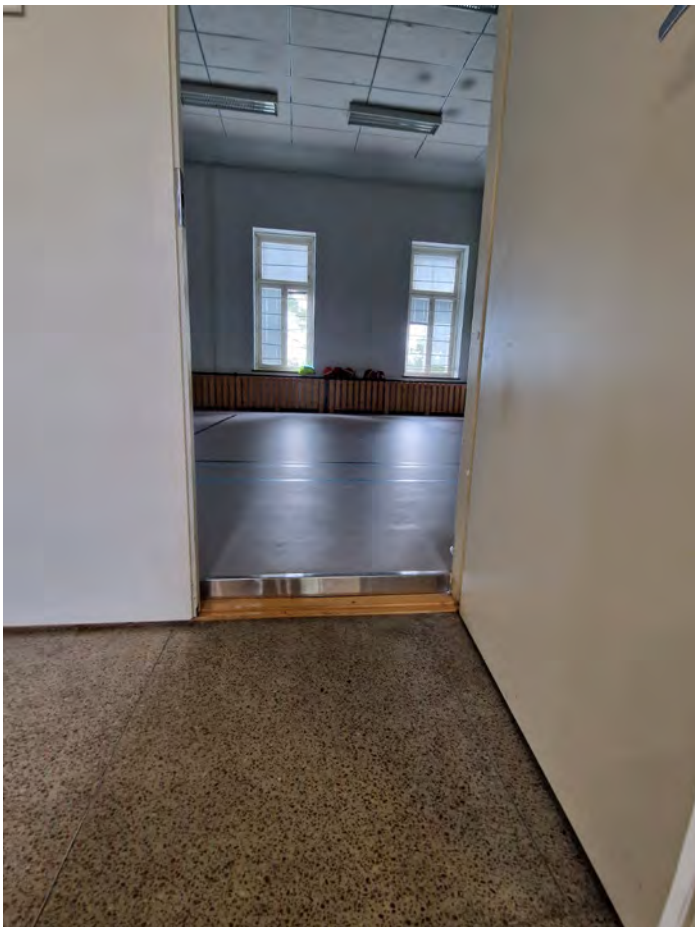
Liikuntasaliin on toteutettu uusi massalattiapintarakenne, jonka vuoksi oviaukossa on huomattava kynnyks. KS
