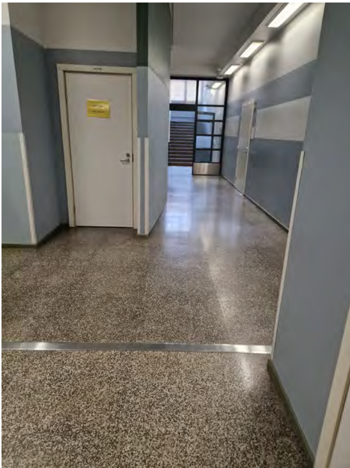
Käytävässä on alkuperäinen mosaiikkibetonilattia. Vuoden 1955 laajennuksen rajalla on ilmeisesti liikuntasäily, joka on peitetty myöhemmin RST-listalla. KS
