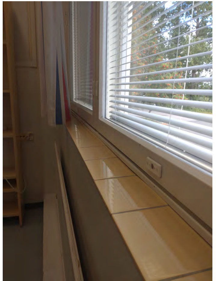
Osaan tiloista on vaihdettu ikkunalaudan kaakelointi. Uusissa reuna ei ole pyörästetty. KS
