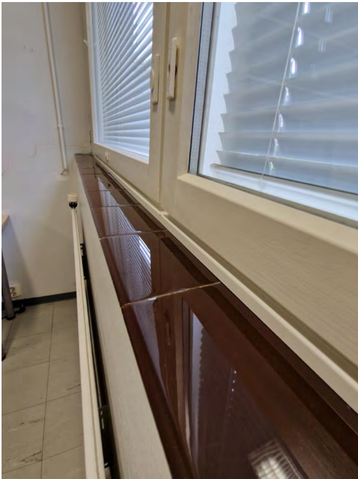
Alkuperäiset kaakelit ikkunalaudalla. Alunperin myös ikkunoiden puitteet ovat olleet tummanruskeat. KS
