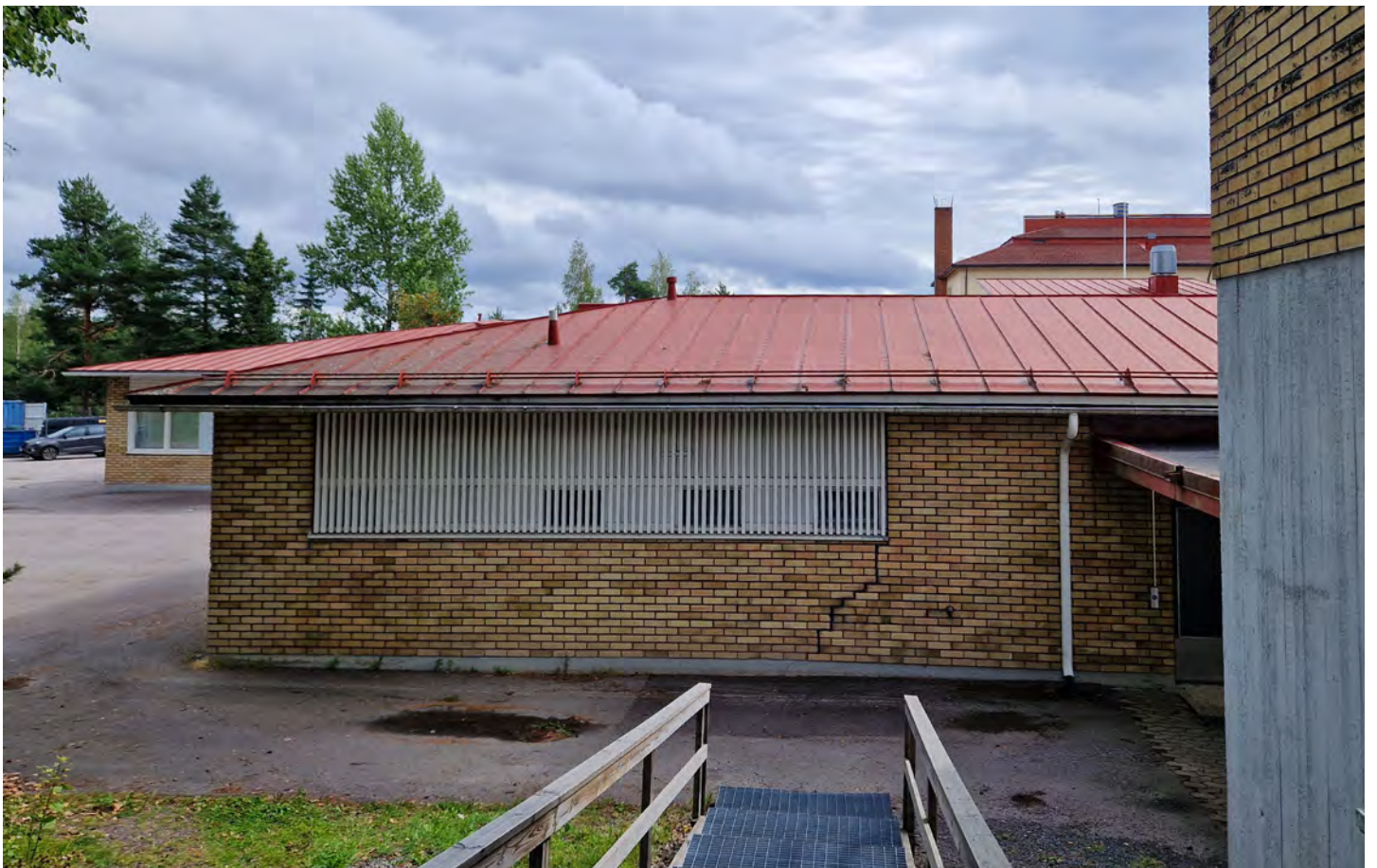
Länsijulkisivussa pukuhuoneen ikkunoiden edessä rimoitus. Julkisivussa suuri halkeama. Punainen peltikate hallitsee julkisivua ylhäältä - aluperin rakennus oli tasakattoinen ja räystäätön. EK
