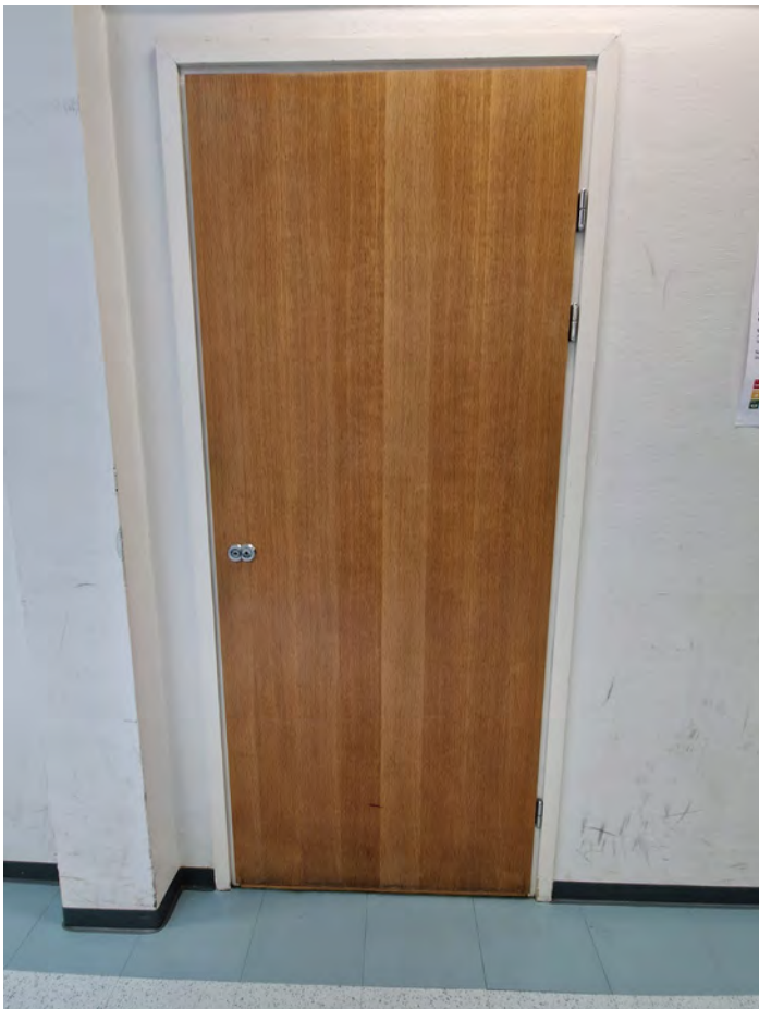
Alkuperäinen viilupintainen ovi sähkökaapissa. EK
