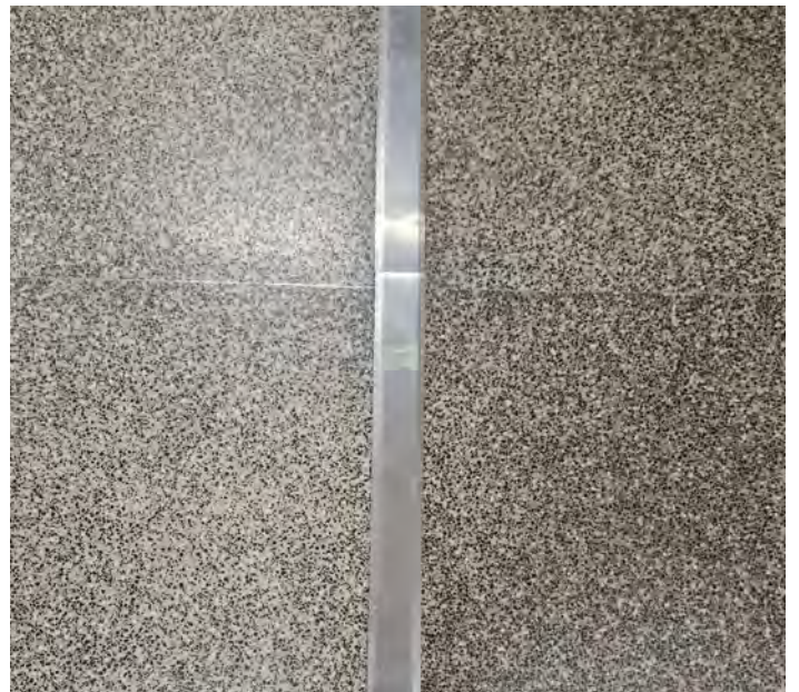
Vuosina 1931 ja 1955 toteutettujen mosaiikkibetonipintojen sävy käytävässä eroaa hiukan toisistaan. Saumaan lisätty myöhem-min RST-lista. EK.
