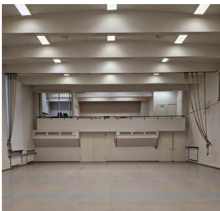
Liikuntasalin ilmanvaihtoa on parannettu vuoden 1998 peruskorjauksessa ja tuloilmalaitteet rikkovat parven alapuolista seinää. EK
