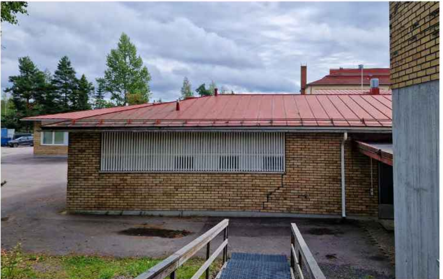
Länsijulkisivussa pukuhuoneen ikkunoiden edessä nimoitus. Julkisivussa suuri halkeama. Punainen peltikate hallitsee julkisivua ylhäältä – aluperin rakennus oli tasakattainen ja räystäätön. EK
