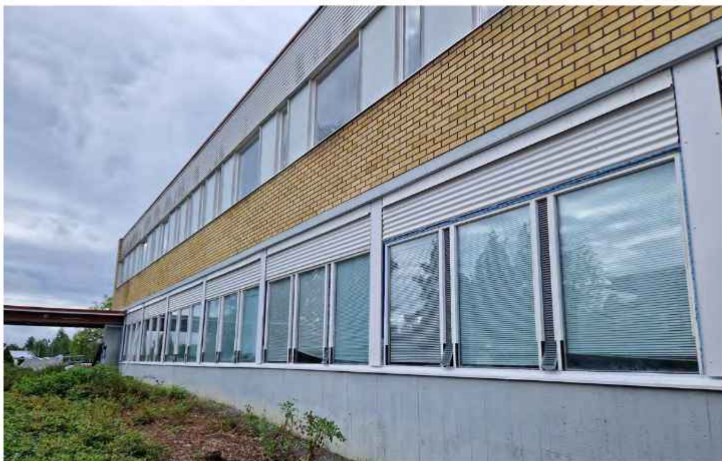
Sisäpihalle aukeava itäjulkisivu on muuttanut ilmeeltään huomattavasti vaaleammaksi. Sekä ikkunat ja niiden ympärykset, että sokkeli olivat alunperin tummanruskeita. Vertaa arkistokuvaan s.53. EK
