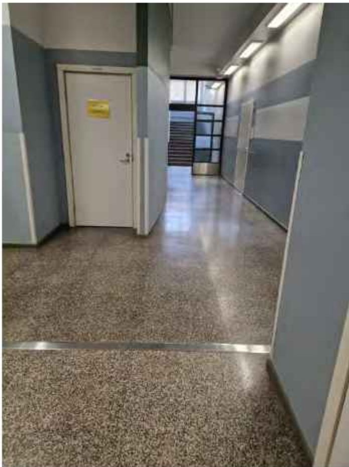
Käytävässä on alkuperäinen mosaiikkibetonilattia. Vuoden 1955 laajennuksen rajalla on ilmeisesti liikuntasauva, joka on peitetty myöhemmin RST-listalla. KS
