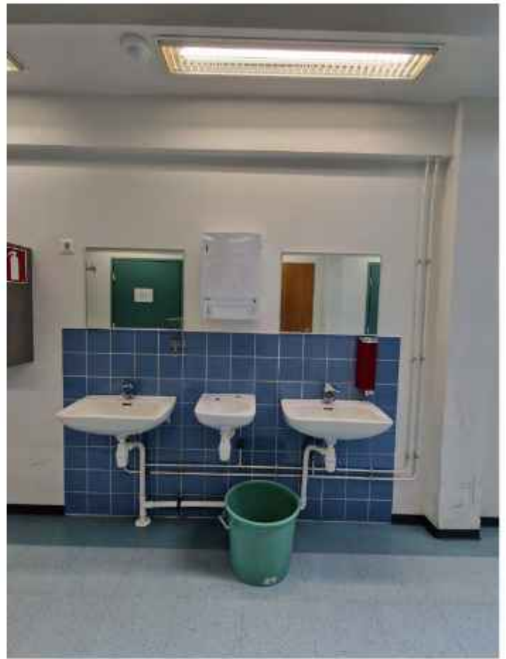
Vesipiste käytävällä, uusittu 1998. KS
