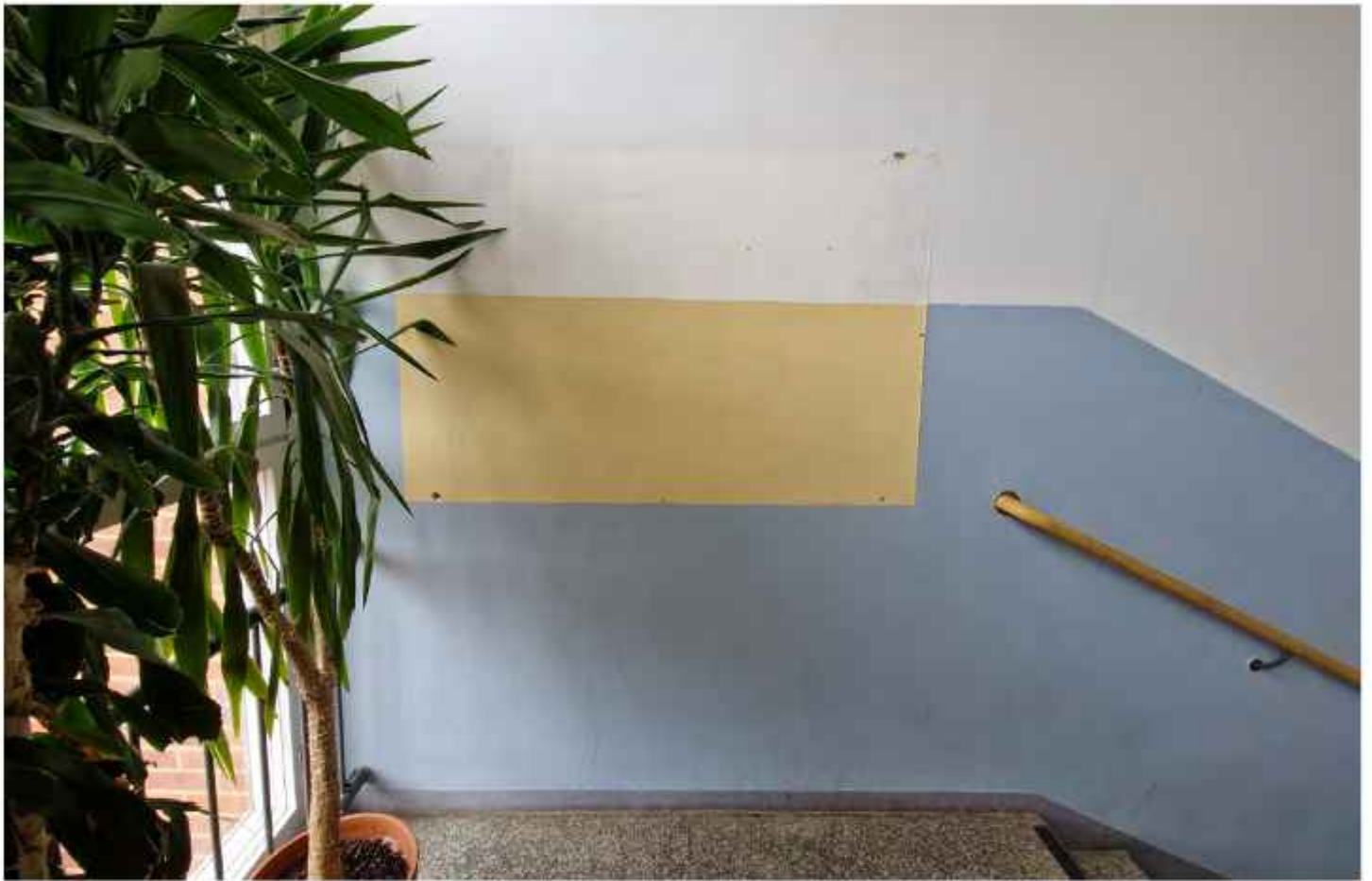
Vanhoja sisävärejä porrashuoneessa siirretyn ilmoitustaulun takaa paljastuneena. EK
