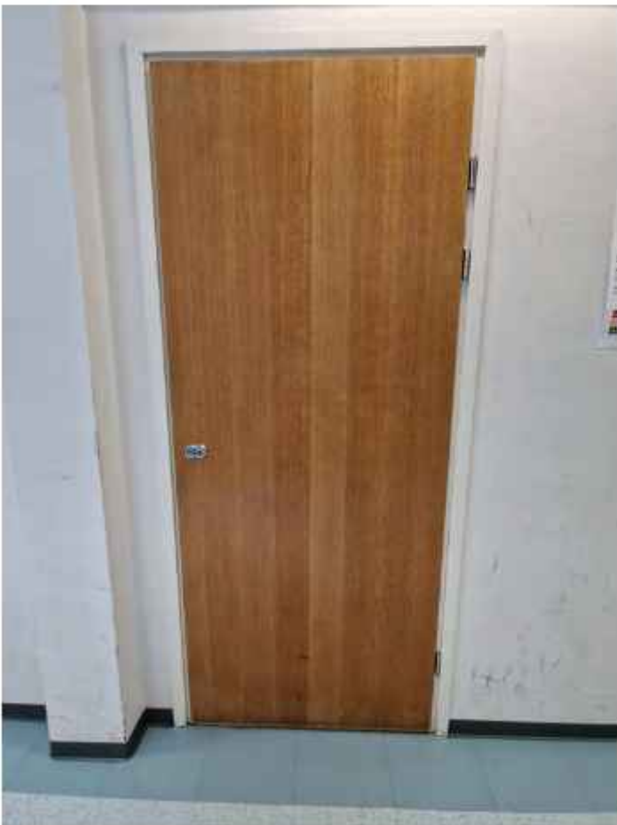
Alkuperäinen viilupintainen ovi sähkökaapissa. EK
