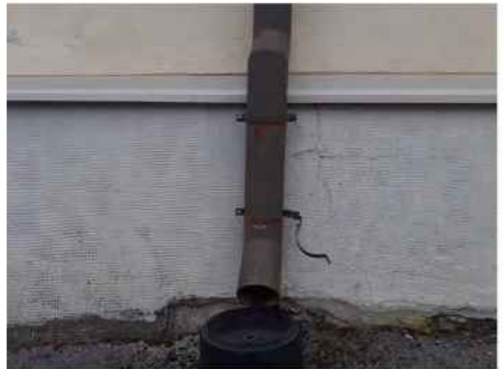
Alkuperäisen osan ja laajennuksen sokkeleissa tekstuuriero. Pintakuvio on todennäköisesti toteutettu kuviotelalla ja kuviointi ollut hiukan erilainen. Saumakohta alkuperäisen ja laajennusosan välissä on piilotettu syöksytorven taakse. KS.
