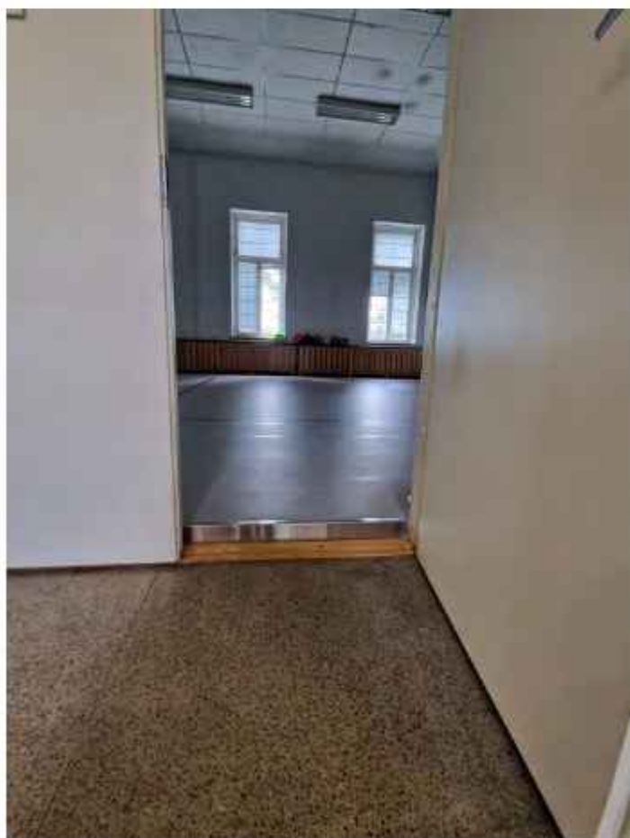
Liikuntasaliin on toteutettu uusi massalattiapintarakenne, jonka vuoksi oviaukossa on huomattava kynnyks. KS
