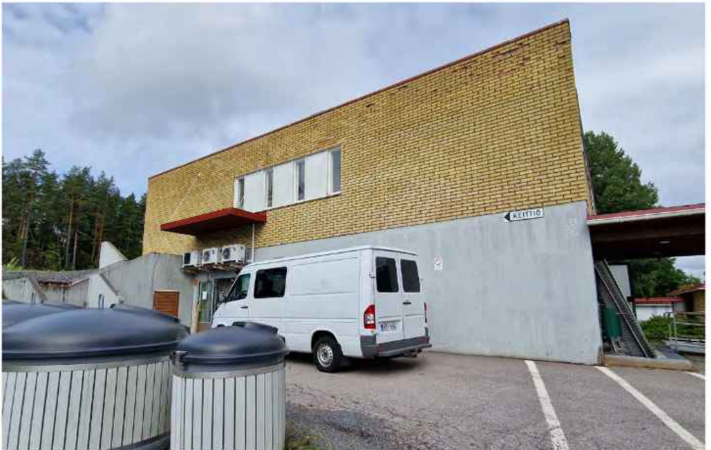
Eteläpäädyssä jo kertaalleen uusittu tiilimuraus on rapautunut. EK
