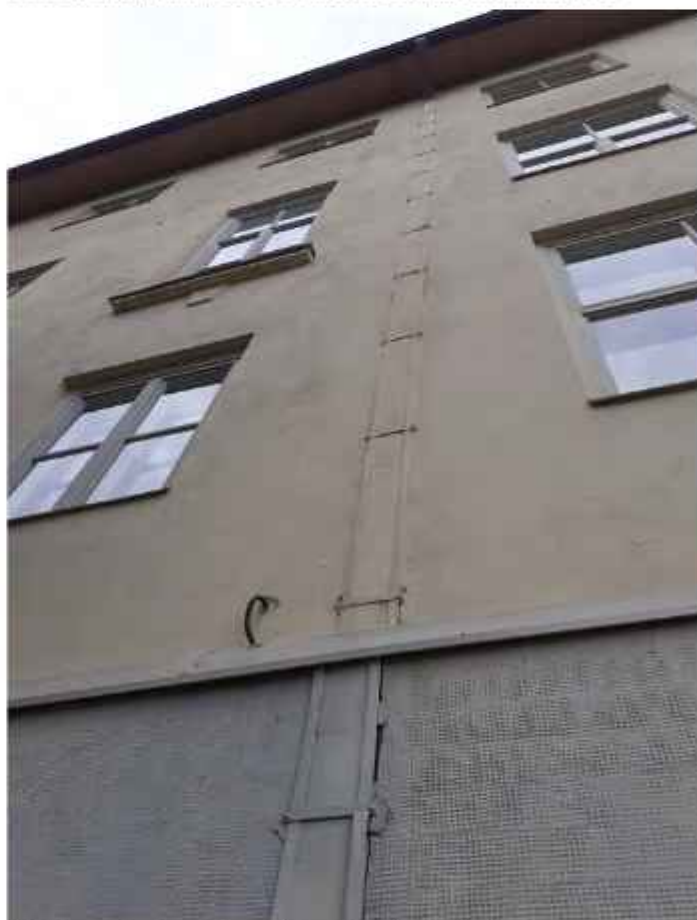
Muista syöksytorvista poiketen itäjulkisivulla laajennuksen saumakohtaan on toteutettu syvännetty syöksytorvi. KS.
