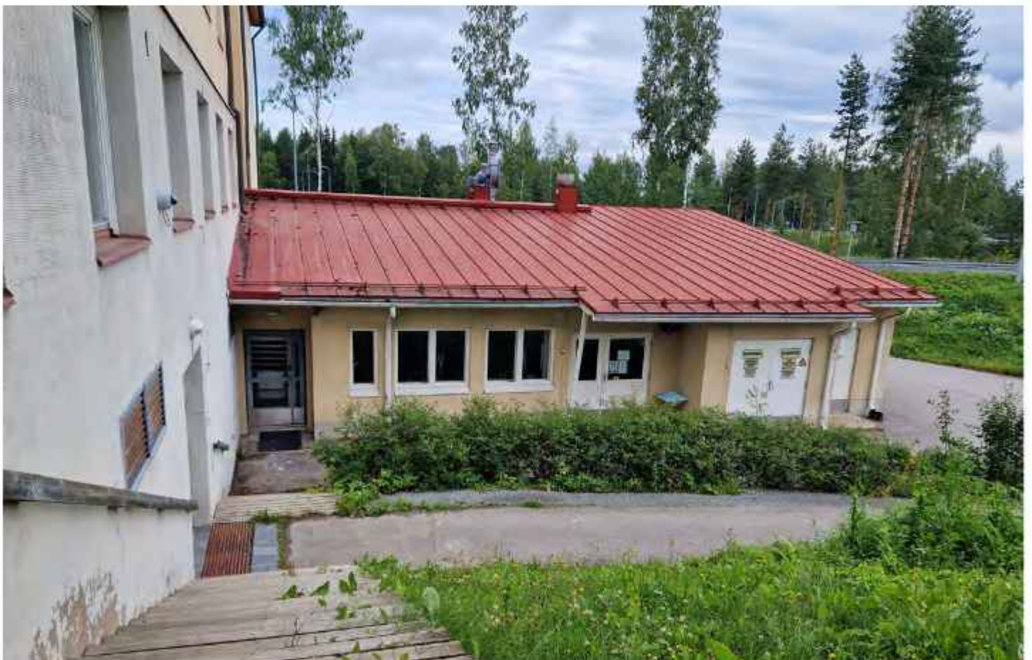
Vuoden 1997 laajennus on alisteinen alkuperäiselle päärakennukselle, ja se jää hiukan syvennykseen. KS.
