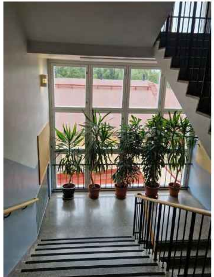
Vuonna 1955 valmistuneen laajennuksen päätyporras. Kaiteet ovat alkuperäiset ja niissä joka kolmas pystyjohde latta. Ikkunat on uusittu. EK
