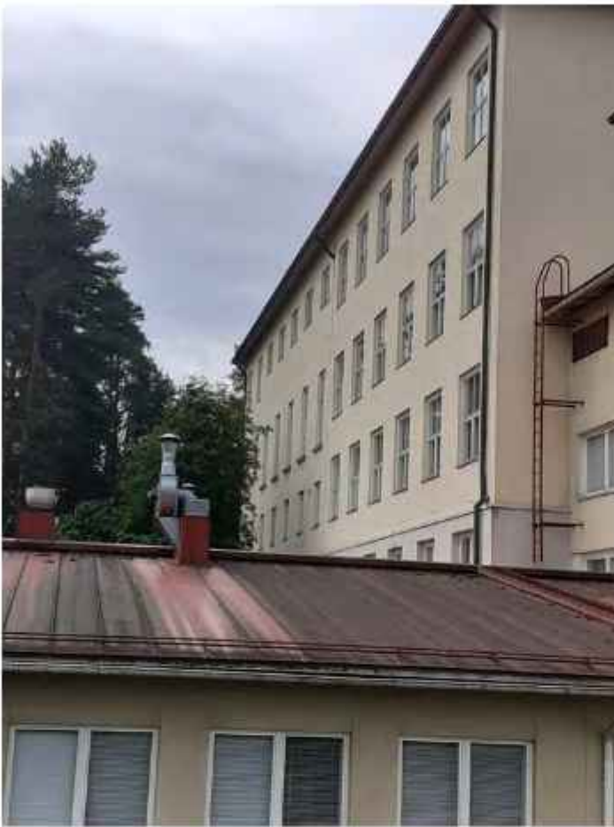
Pohjoisesta kuvattun itäjulkisivua, jossa näkyy julkisivun eri kokoiset ikkuna-aukot. Vanhan salin ikkunoiden alareunassa levennetty muuraus. KS.
