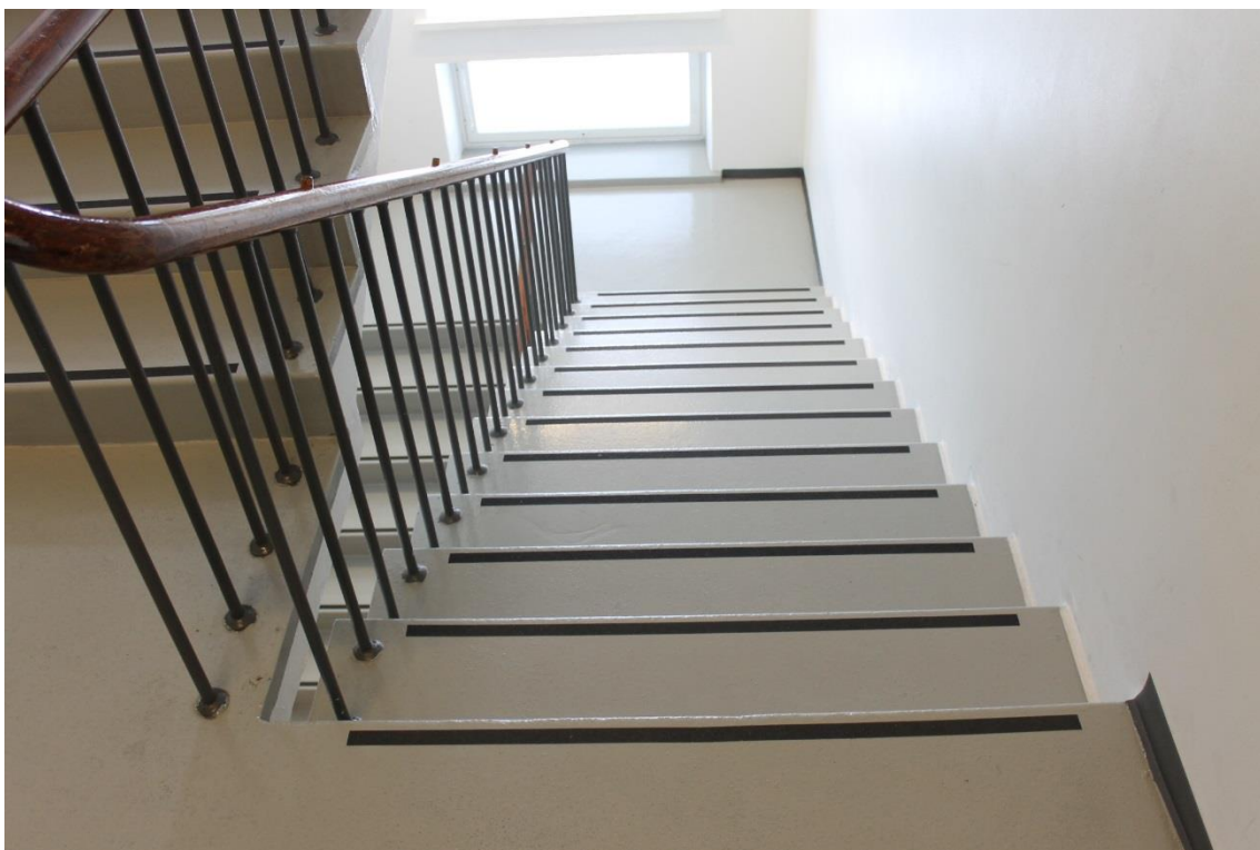
Kuva144. Porrasaskelmissa on kontrastiraidat. Käsijohde puuttuu toiselta puolelta. Käsijohde ei ole yhtenäinen tasanteella.
