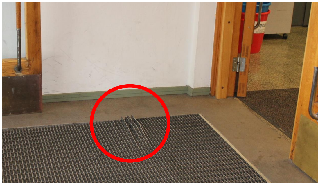
Kuva81. Tuulikaapin maton reuna on noussut ja se voi aiheuttaa kompastumisvaaran.
