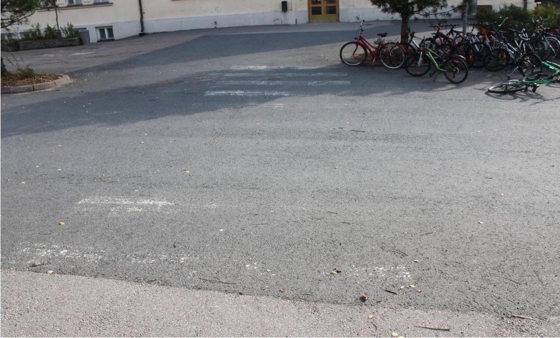
Kuva78. Suojatien maalaukset ovat kuluneet.
