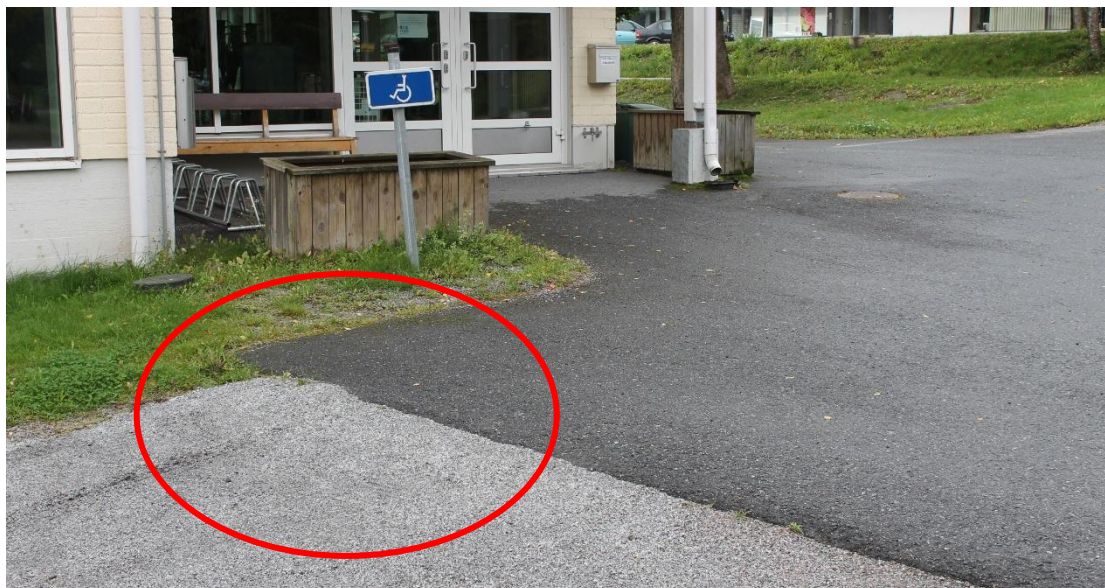
Kuva63. LE-autopaikka ei ole kokonaan asfaltoitu. Maasta puuttuu paikan merkintä viivoilla ja ISA-tunnuksella.
