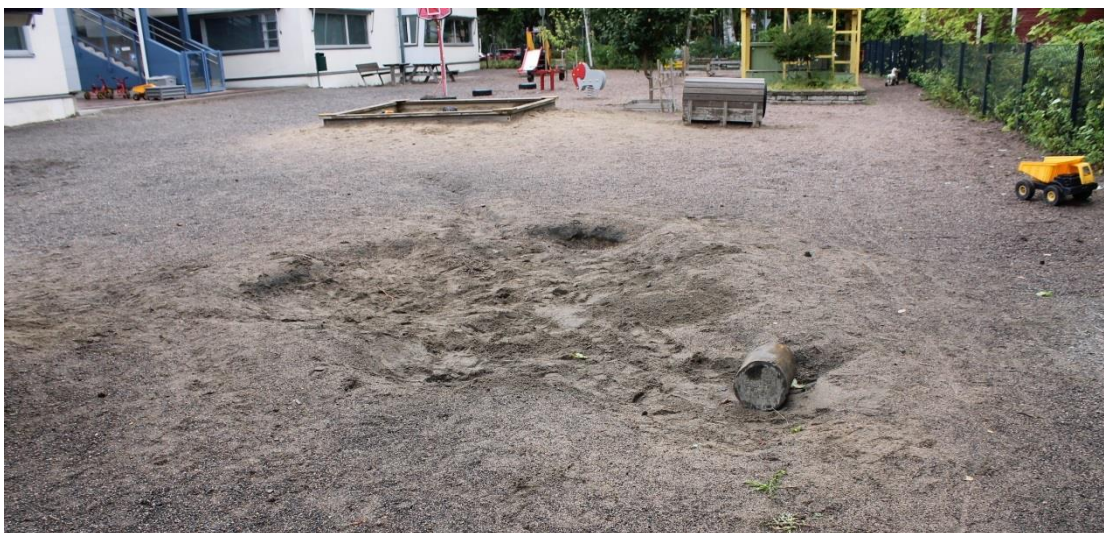
Kuva167. Piha-alueella on kaivettu kuoppia. Kuopat ovat osittain kulkuväylällä portilta sisäänkäynnille. Aluetta ei ole rajattu ja se erottuu huonosti. Epätasaisuudet voivat aiheuttaa kompastumisvaaraa.
