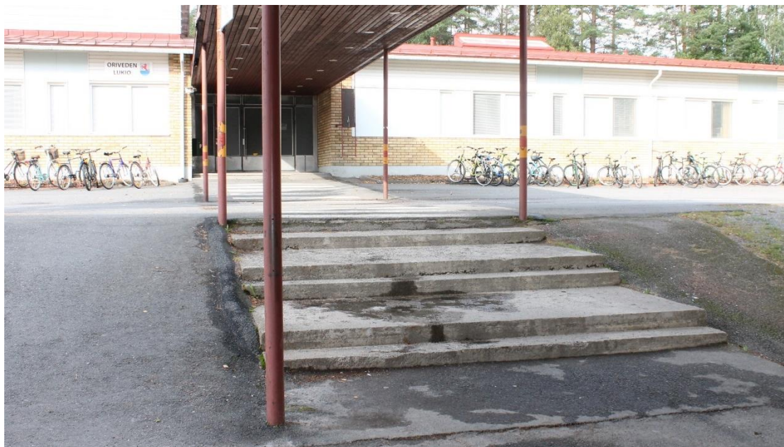
Kuva80. Kulkuväylä yhteiskoululta lukioon on katettu. Portaiden yhteydestä puuttuvat käsijohteet. Portaiden vieressä oleva asfaltoitu reitti on liian jyrkkä esteettömäksi kulkureitiksi.
