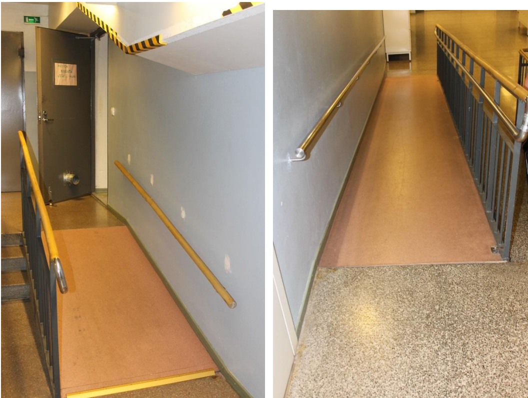
Kuva 91. Luiska on liian jyrkkä. Luiska kohdalla kulkuväylän korkeus ei ole riittävä. Yläpuolisia rakenteita on merkitty huomiotarralla. Oikealla luiska alapäähän on sijoitettu kaluste.
