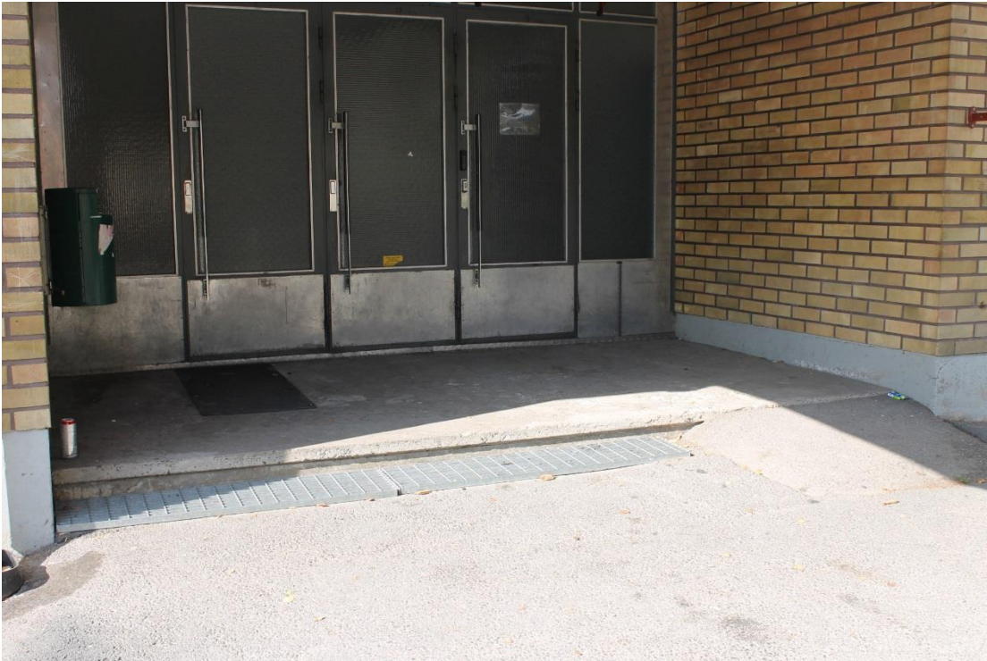
Kuva82. Sisäänkäynnin edustalla oleva luiskattu kulkuväylä on liian jyrkkä. Luiskasta puuttuvat käsijohteet.
