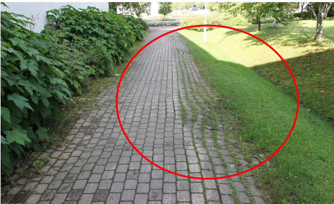
Kuva50. Laatoitus on päässyt painumaan.
