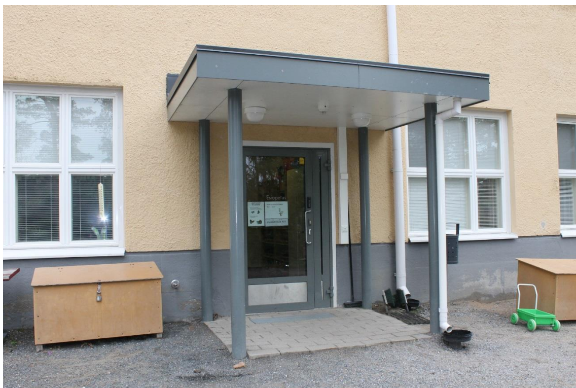
Kuva132. Sisäänkäynti on katettu. Tasanteen edustalta hiekkaa on päässyt kulumaan. Tasoero voi muodostua liian suureksi, jos hiekkaa kuluu lisää.
