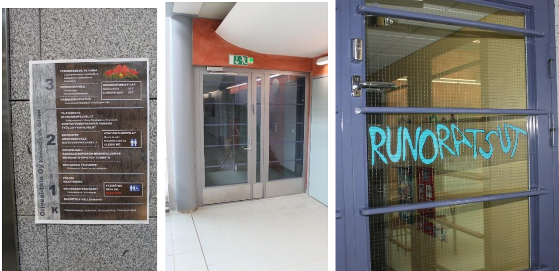
Kuva173. Reitti päiväkodille on osittain opastettu. Toisesta kerroksesta palo-ovelta puuttuu opaste.
