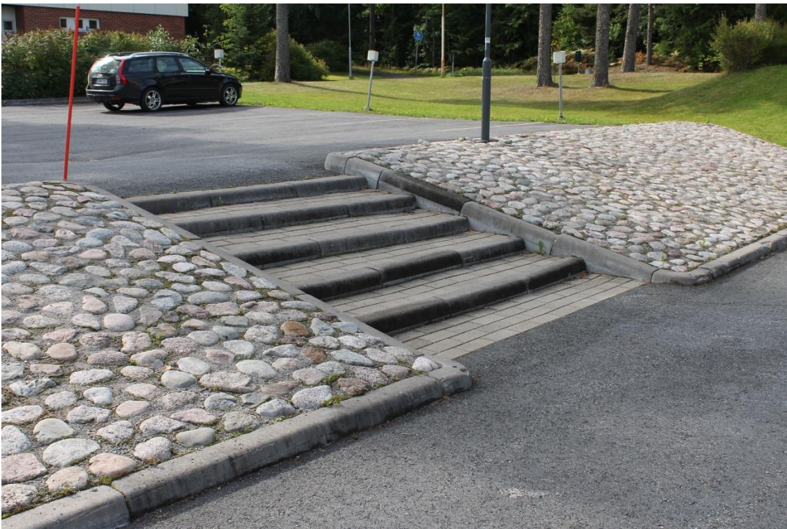
Kuva116. Portaista puuttuvat käsijohteet.
