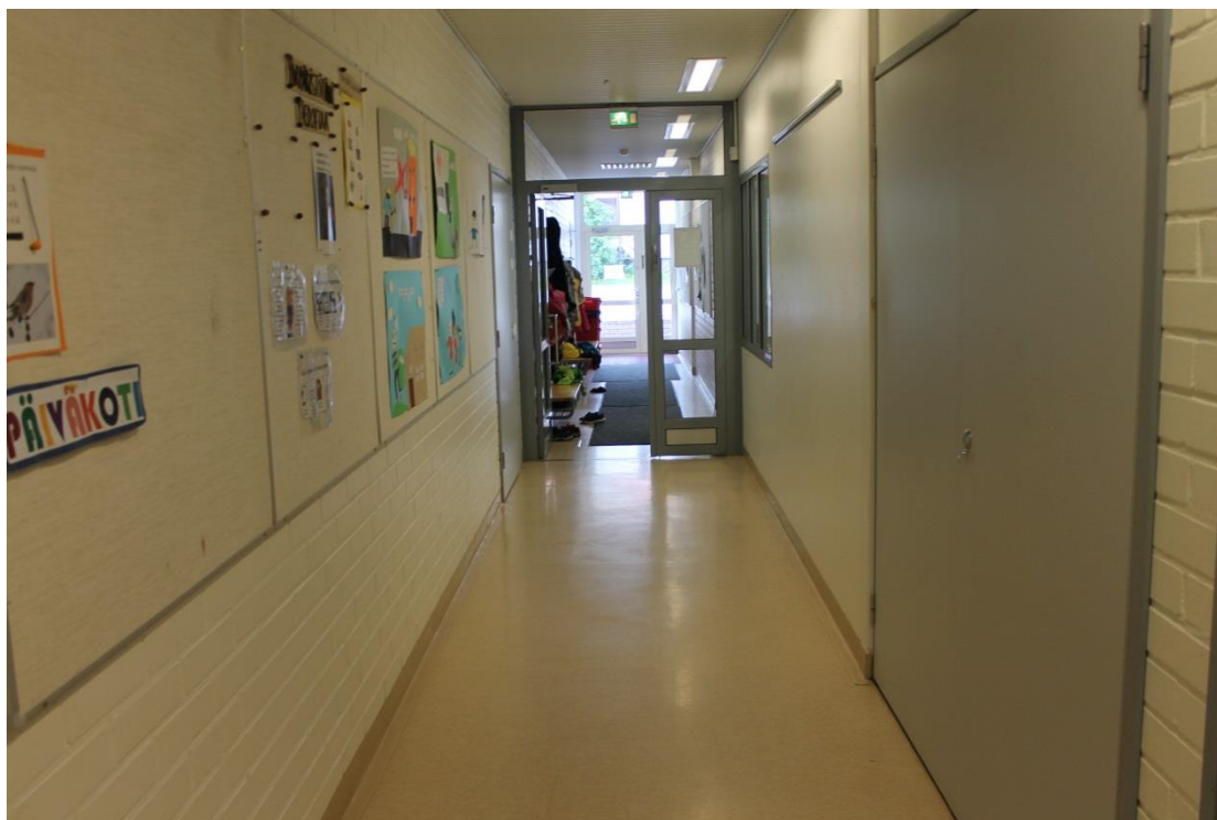
Kuva156. Käytävän varrella oleva palo-ovi on liian kapea.
