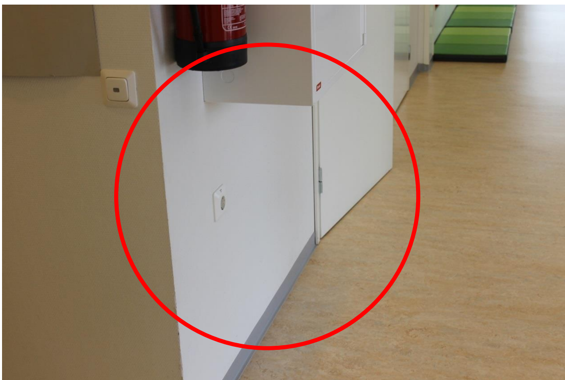
Kuva108. Huonosti erottuva paloposti ja suojaamaton pistorasia.
