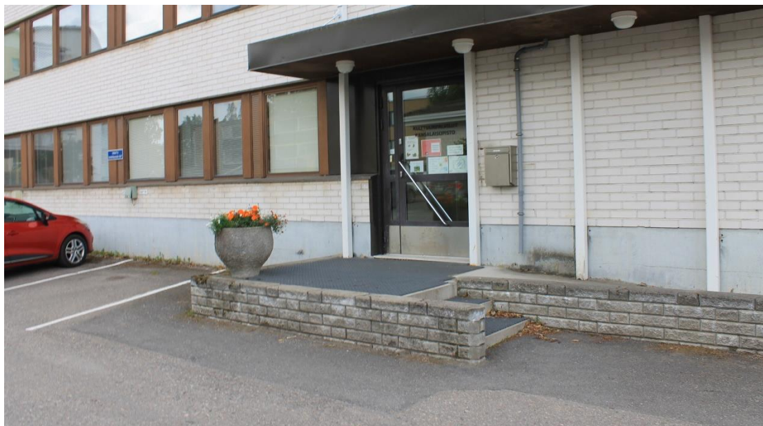
Kuva11. Luiskasta ja portaista puuttuu käsijohteet ja tasanteelta kaide.
