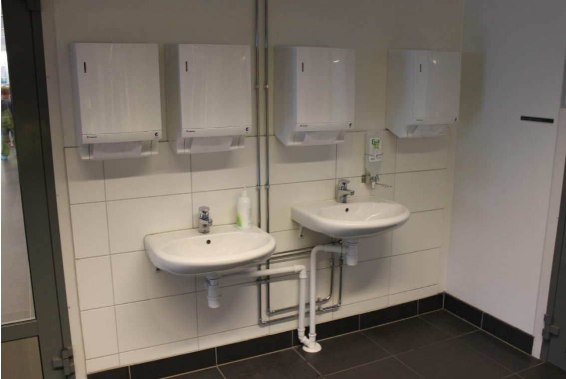
Kuva138. Käsienpesualtaat on sijoitettu kahdelle tasolle. Käsipyyheautomaatit ovat liian korkealla.
