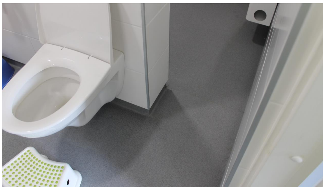
Kuva163. Kulkuaukko päiväkodin puolelta esteettömään wc-tilaan on kapea, eikä siitä mahdu pyörällisen apuvälineen kanssa.
