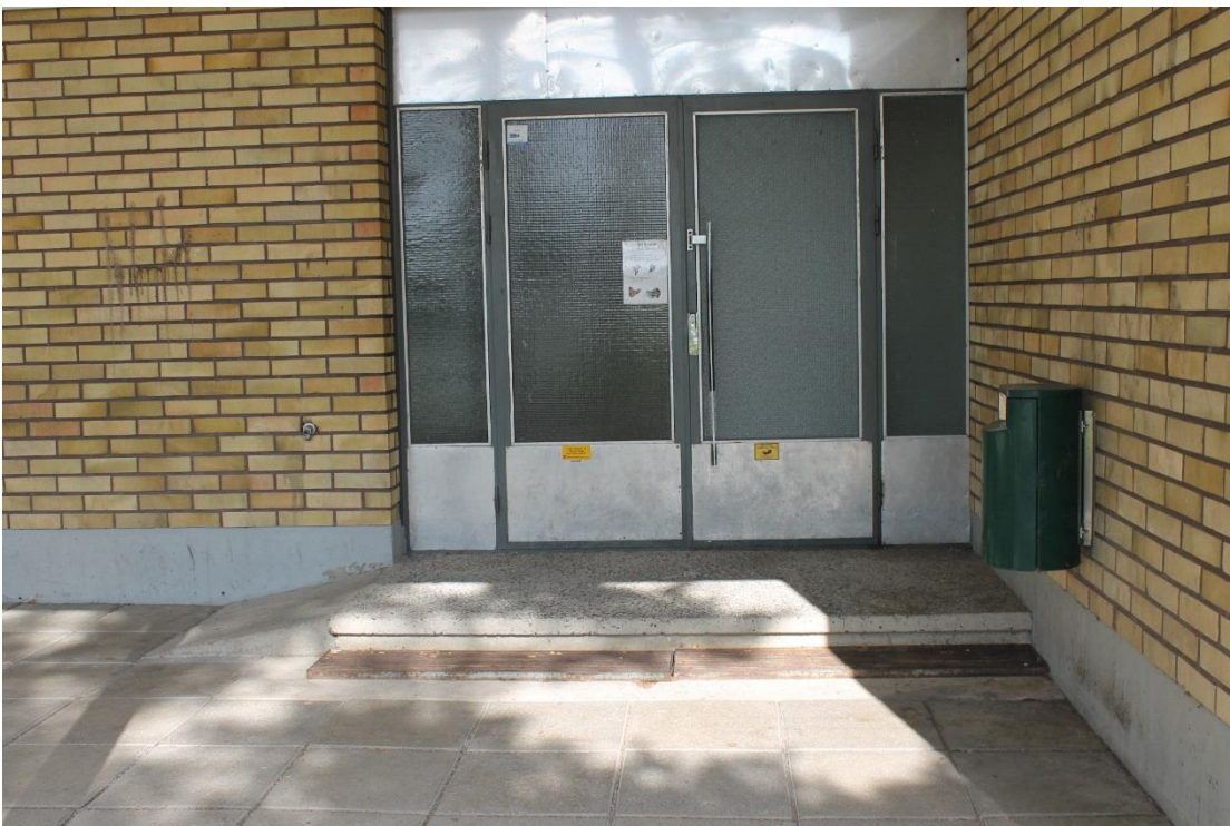
Kuva83. Sisäänkäynnille johtaa liian jyrkkä luiska. Luiskasta puuttuvat käsijohteet ja suorareuna.
