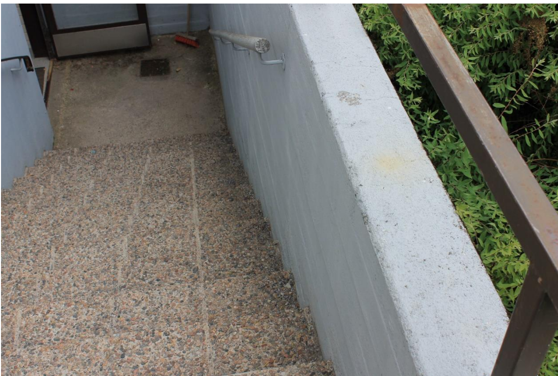
Kuva19. Porrasaskelmat erottuvat huonosti kontrastina toisistaan. Käsijohde ei ole riittävän pitkä.
