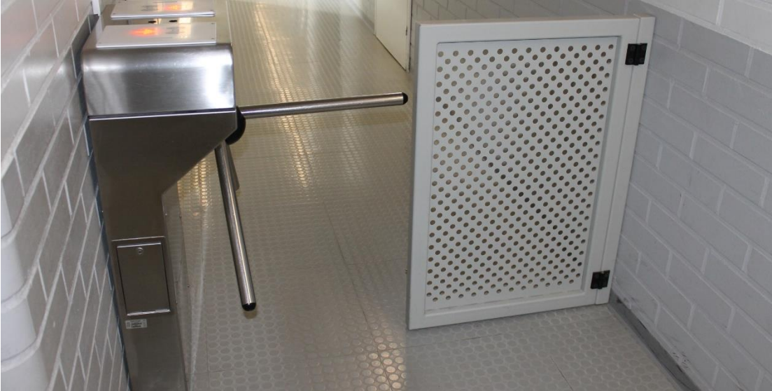
Kuva54. Kuntosalille johtava portti ei sovellu käytettäväksi apuvälineen kanssa. Portin vieressä oleva levy on lukittu, eikä se ole avattavissa itsenäisesti.
