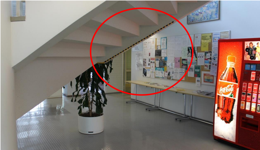
Kuva56. Törmäysvaara portaan alla. Kohta on merkitty huomioraidalla, mutta sen näkyvyyttä voitaisiin parantaa. Kulua voitaisiin ohjata/rajata esimerkiksi sijoittamalla portaan alle kaluste.
