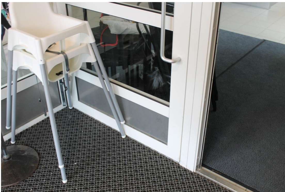
Kuva65. Tuulikaapissa on ylimääräisiä tavaroita, jotka vähentävät tuulikaapin vapaata tilaa.
