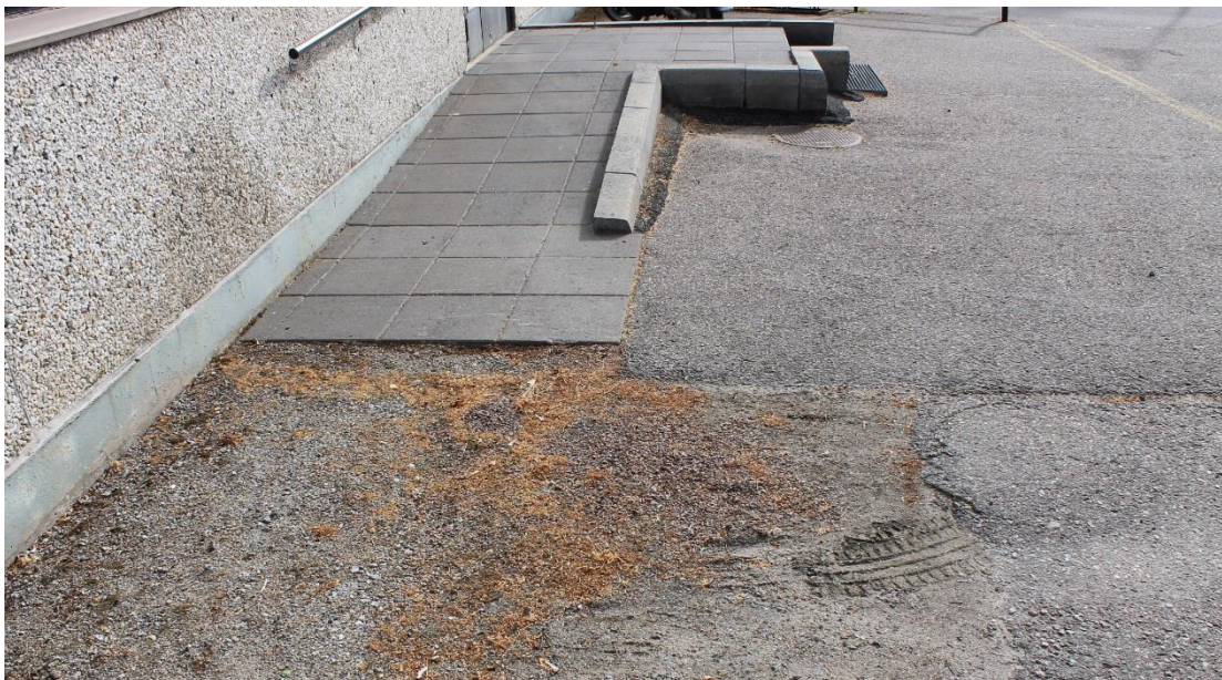
Kuva 34. Luiskan alkupäässä ei ole asfalttia. Luiskasta puuttuu käsijohde toiselta puolelta. Käsijohdeen päätä ei ole käännetty alas; vaatteet voivat tarttua käsijohdeen putkeen.
