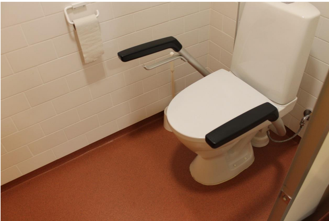
Kuva178. Käsituellinen wc-istuin on sijoitettu pesuhuoneen yhteyteen. Wc-istuimen kummallekaan puolelle ei jää riittävästi vapaata tilaa, eikä wc sovellu esteettömäksi.
