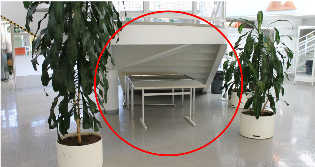
Kuva57. Törmäysvaara portaan alla. Kohta ei ole merkitty huomioraidalla.
