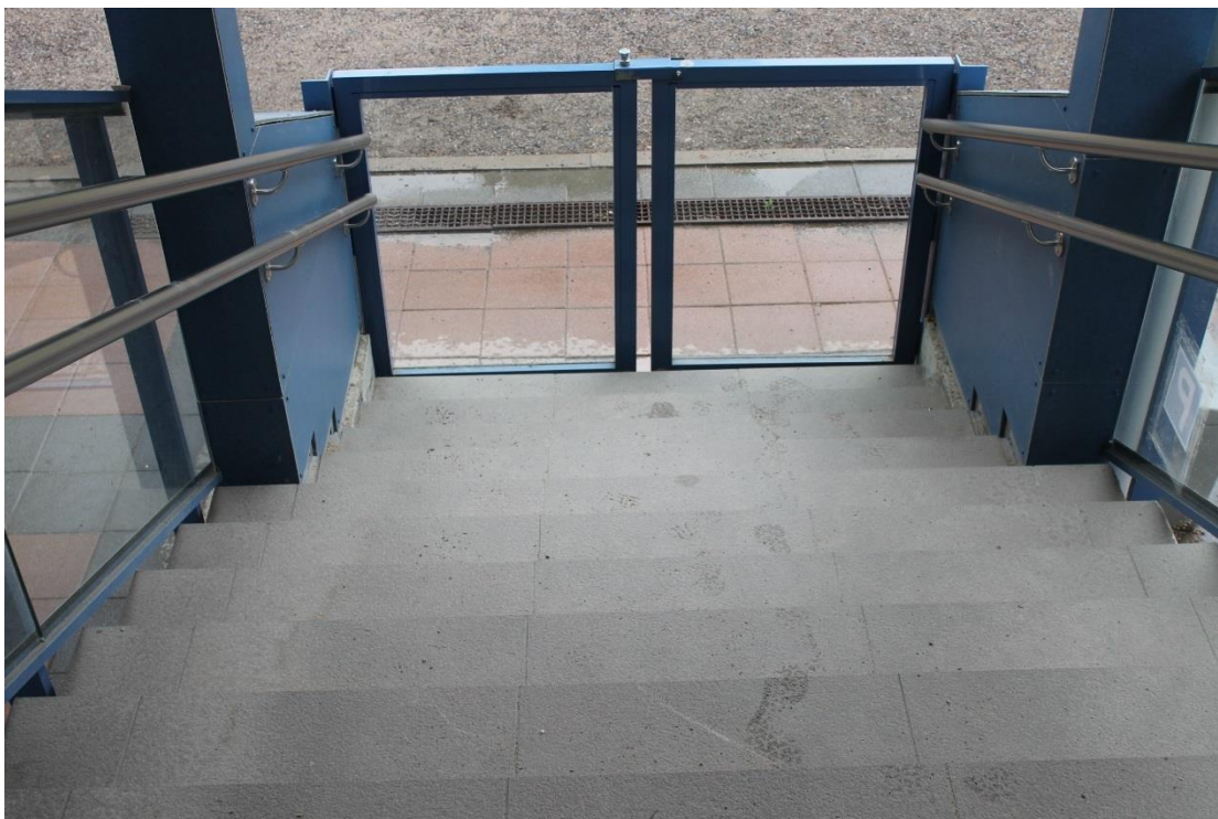
Kuva170. Toiseen kerrokseen johtavien portaiden askelmia on hankala hahmottaa.
