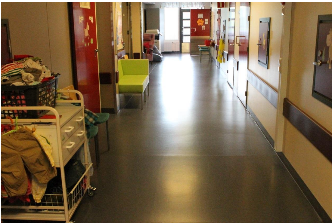
Kuva 30. Käytävälle muodostuu heijastusta päädyn ikkunasta.
