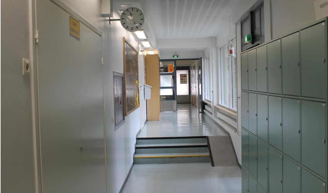
Kuva 95. Portaiden yhteydestä puuttuvat käsijohteet. Luiska on liian kapea ja jyrkkä ja siitä puuttuvat käsijohteet.
