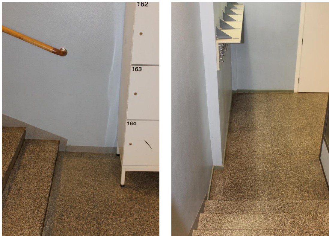
Kuva 90. Suoraan portaan kohdalle sijoitettu lokerikko ja kulkuväylälle sijoitettu naulakko voivat aiheuttaa törmäysvaaran. Oikealla kuvassa käsijohde puuttuu kokonaan toiselta puolelta porrasta.
