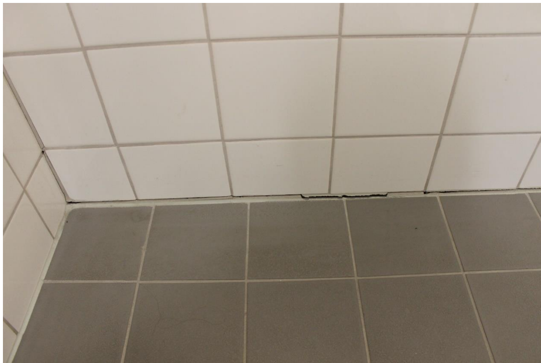
Kuva7. Wc-tilan takaseinässä on halkeamia. Seinärakenteen kunto kannattaa tarkistaa.
