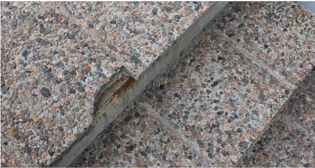
Kuva18. Porrasaskelmasta on lohjennut pala.
