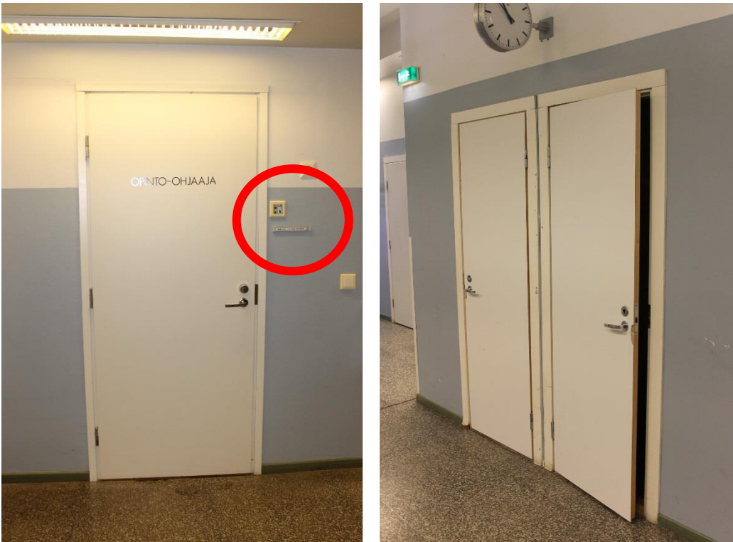
Kuva 86. Ovisummeri on liian korkealla. Opaste on sijoitettu suoraan oveen ja nimikyltti oven avautumispuolelle seinään. Oikeanpuoleisessa kuvassa on wc-tilat, mutta niiden ovien yhteydestä puuttuvat opasteet kokonaan.
