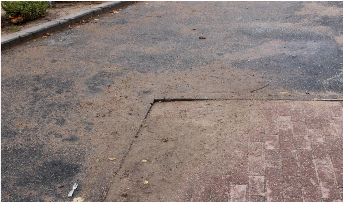
Kuva4. Laatoituksen kohdalla oleva pykälä voi aiheuttaa kompastumisvaaraa.
