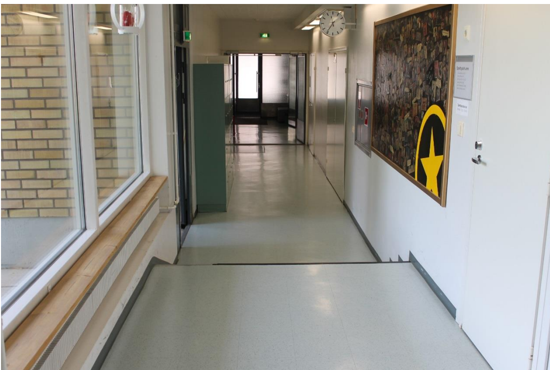
Kuva 96. Kulkuväylän jatkeena olevien portaiden alkamiskohta ei erotu. Hahmottamista auttaisi lattiaan merkitty kontrasti portaalan alkamis- ja päättymiskohtaan. Myös käsijohteiden asentaminen auttaa hahmottamaan, että kulkuväylällä on portaat.
