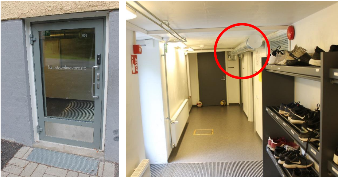
Kuva137. Liikuntavälinevarastossa huonekorkeus on liian matala. IV-putket aiheuttavat törmäysvaaran.
