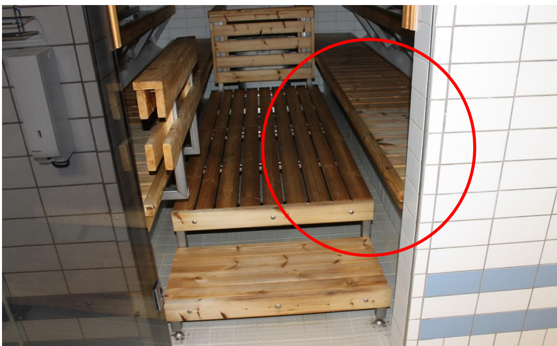
Kuva74. Saunan portaista puuttuu käsijohde/tuki toiselta puolelta portaita.
