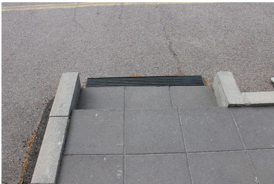
Kuva 35. Portaista puuttuu käsijohteet. Porraskaskelman materiaali on samaa kuin tasanteen, askelma voi olla hankala hahmottaa.
