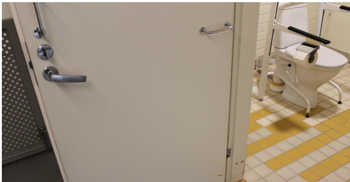
Kuva62. Ovesta puuttuu yhtenäinen vaakasuuntainen lankavedin.
