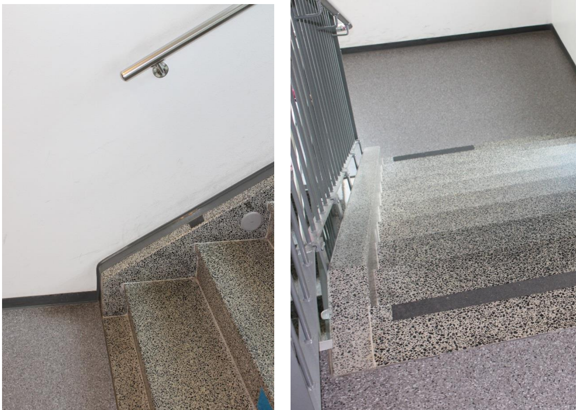
Kuva143. Käsijohde päättyy liian aikaisin ensimmäisen portaan kohdalla. Käsijohteen tulee ulottua 300mm yli portaan alkamis- ja päättymiskohdan. Porrasaskelmat erottuvat huonosti kontrastina.
