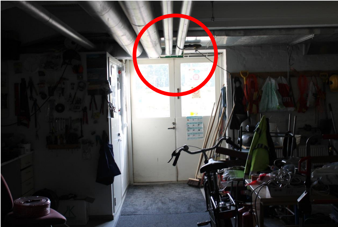
Kuva 100. Uloskäynnin merkki on piilossa putkien takana eikä näy.
