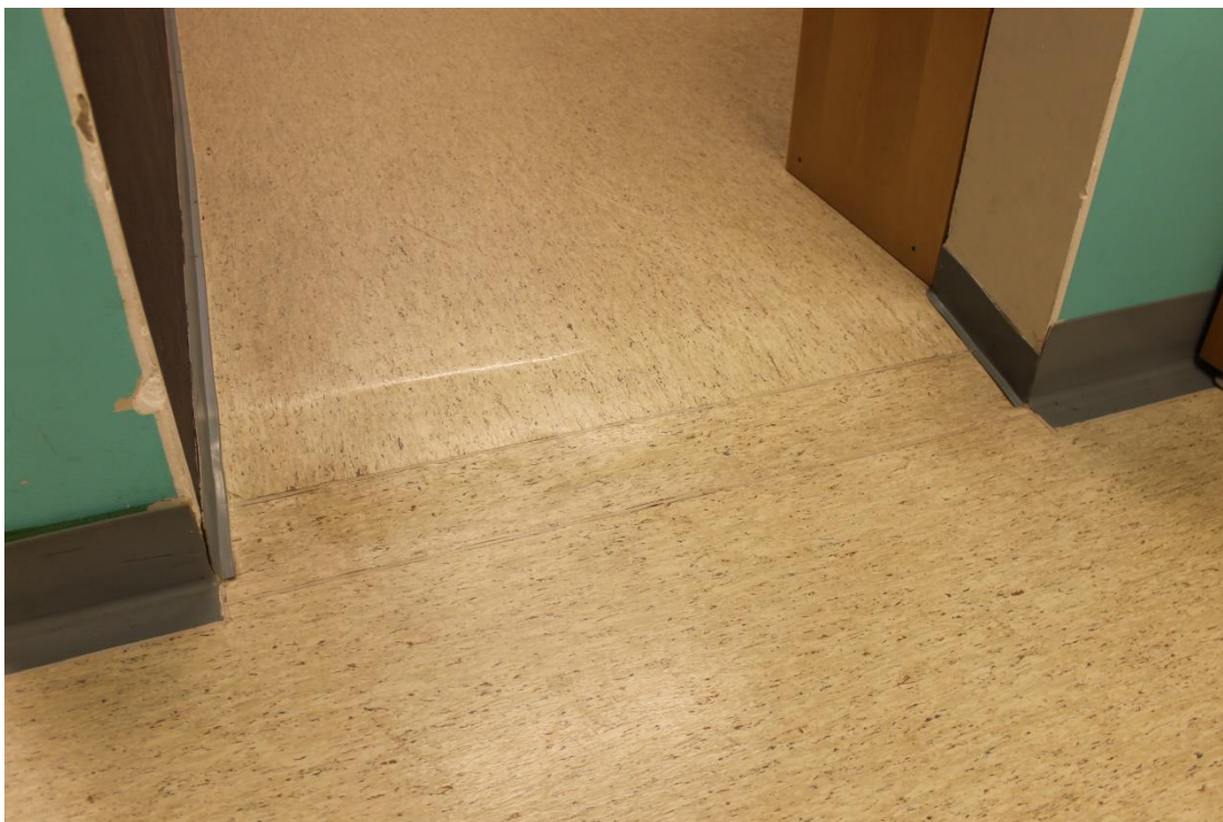
Kuva13. Kirjastossa on lastenosastolla huoneisiin luiskattu kulkuväylä, jota ei ole merkitty.
