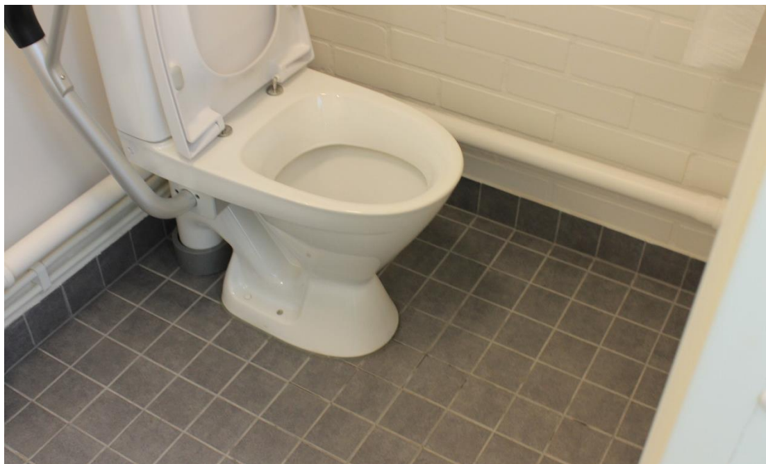
Kuva 41. Esteettömäksi merkitty wc-tila on mitoitukseltaan liian pieni. Wc-istuimen eteen ei jää riittävästi tilaa ja tilaan jäävä vapaa pyörähdysympyrä on liian pieni.
