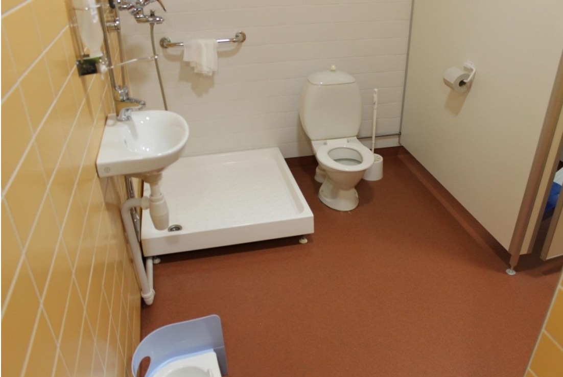
Kuva177. Suihkun alla on koroko, jossa on vedenpoisto. Koroke ei sovellu käytettäväksi apuvälineen kanssa.
