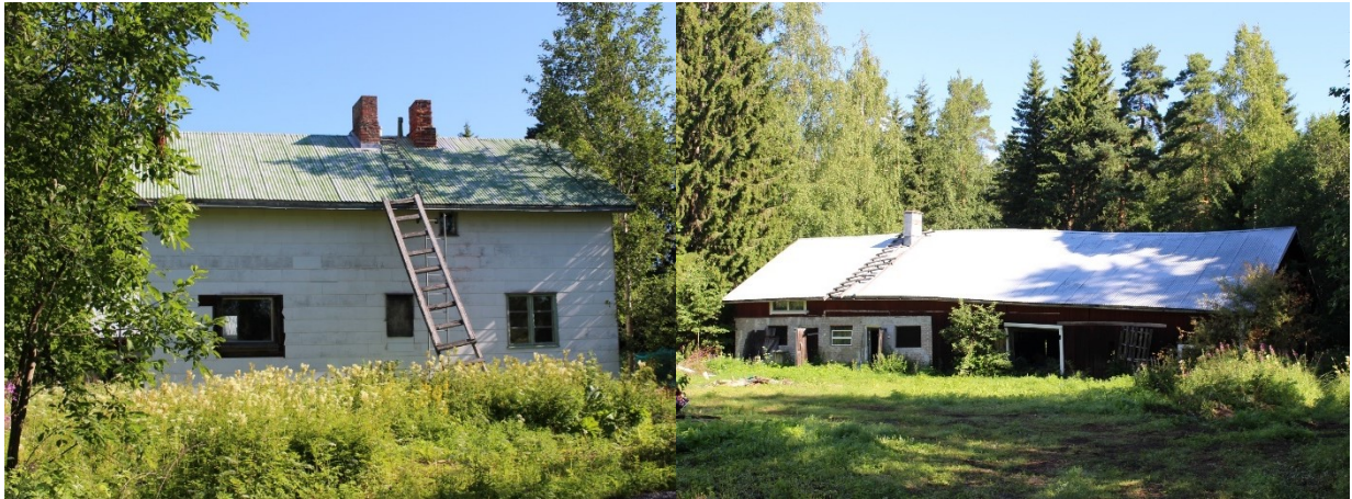
Kuva 15. Tilan Somila purkukuntoinen asuinrakennus (vas.) ja talousrakennus (oik.) kuvattuna heinäkuussa 2024.
