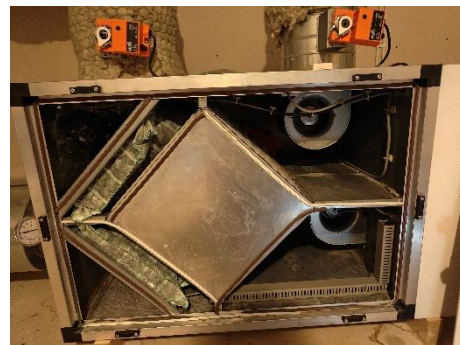
Kuva 33. Konepaketti sisältä ja sulkupeltimottorit
