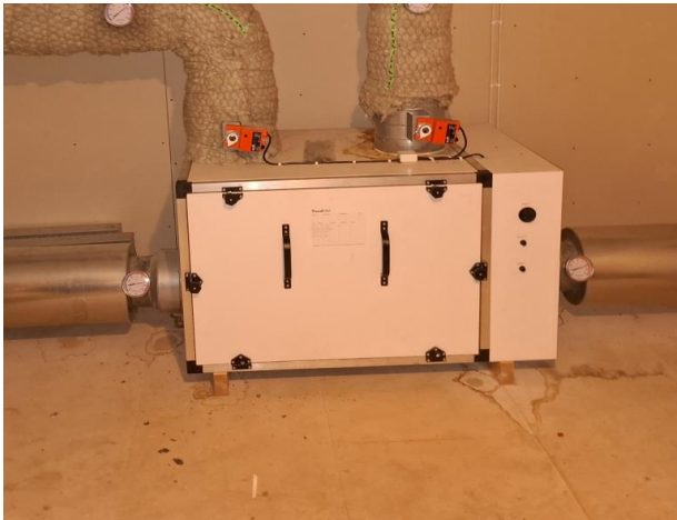
Kuva 24. Vesivuotojälkiä IV-koneen alla.
