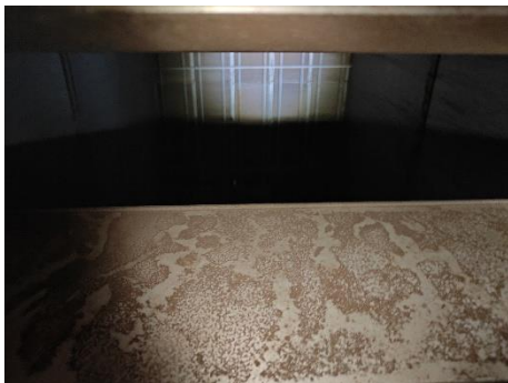
Kuva 49. TK03 lämmönsiirtimen vaihdin-luukku
