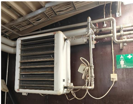
Kuva 39. Puhallinkonvektori ja säätöventtiilit
