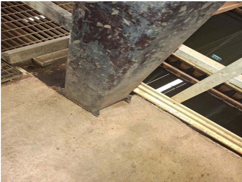
Kuva 13. Rakennuksen alkuperäisosan teräspilarin juuri.
