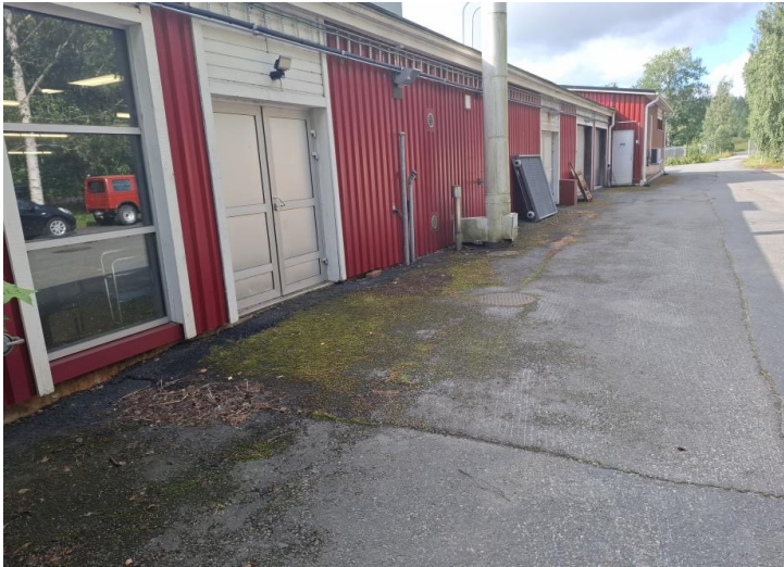
Kuva 4. Sammaloituneita asfalttialueita pohjoispuolella.
