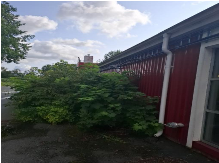
Kuva 5. Villiintynyttä kasvillisuutta pohjoispuolella.
