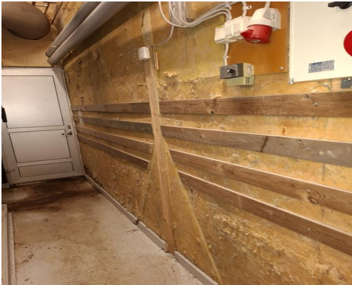
Kuva 34. Tilassa oli pinnoittamattomia ja kolhiintuneita akustovillalevyjä.
