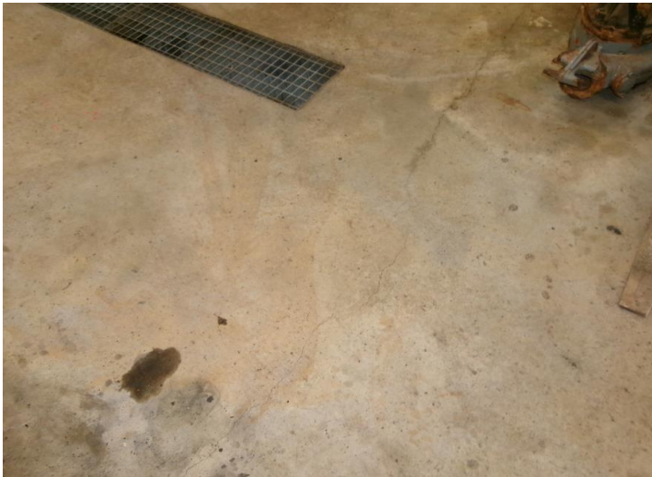
Kuva 32. Korjaamotilan lattialla halkeama.
