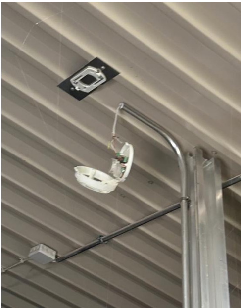
Kuva 1 Palovaroittimet tulisi tarkastaa ja uusia tiloihin soveltuviksi
