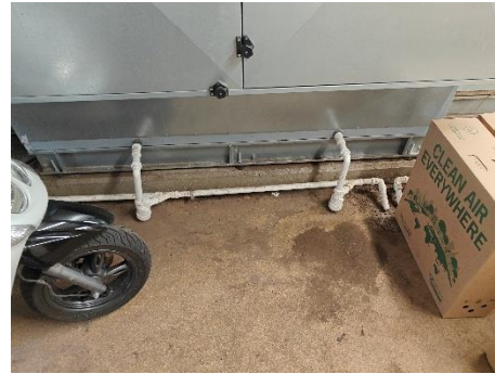
Kuva 48. TK03 kondenssivedet ohjattu lat-tiakaivoon
