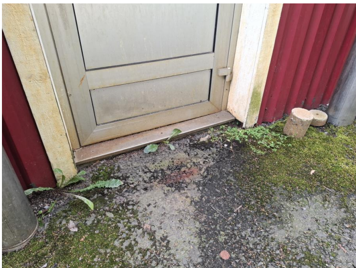
Kuva 16. Ulko-oven puulistat melkein asfaltin pinnassa kiinni.
