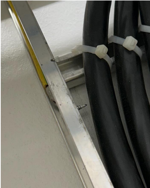
Kuva 60. Maadoitus liitetty riskialttiisti pääkeskuksen tilassa. Teräväpäisiä ruuveja ei saisi käyttää.
