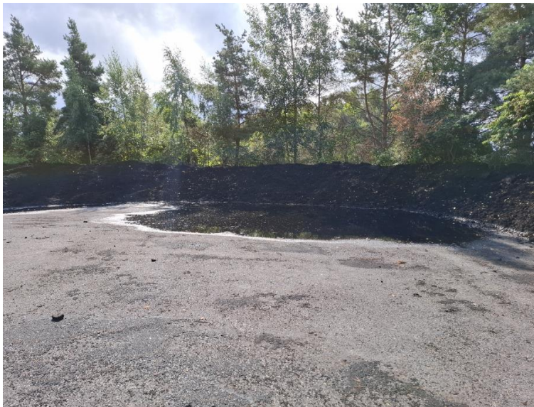
Kuva 2. Tukkeutuneesta sadevesiviemäristä johtunut lammikko.
