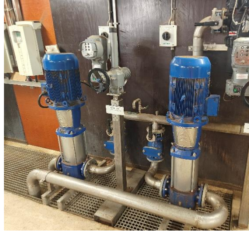
Kuva 41. Teknisen veden pumppaamo
