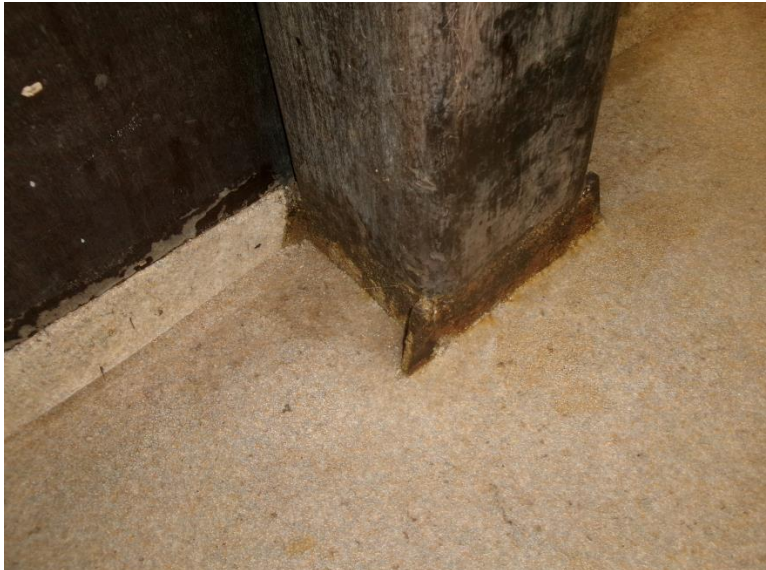
Kuva 12. Rakennuksen alkuperäisosan teräspilarin juuri.
