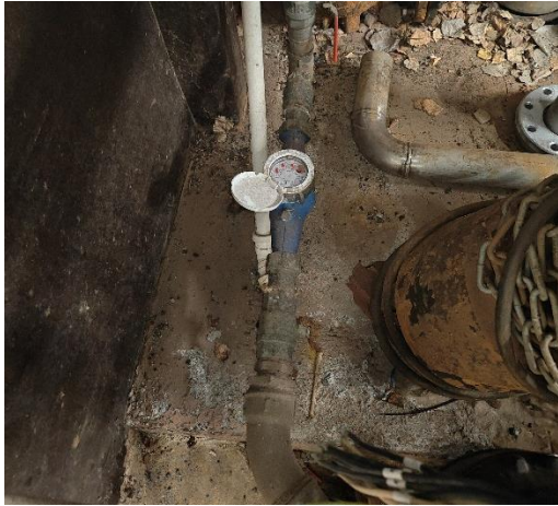
Kuva 40. Vesimittari ja pääsulku
